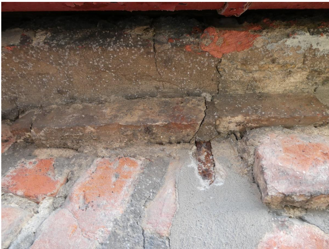
Under arbete. Södra fasaden. I takfoten finns järn som rostsprängt cementhaltig fog.
