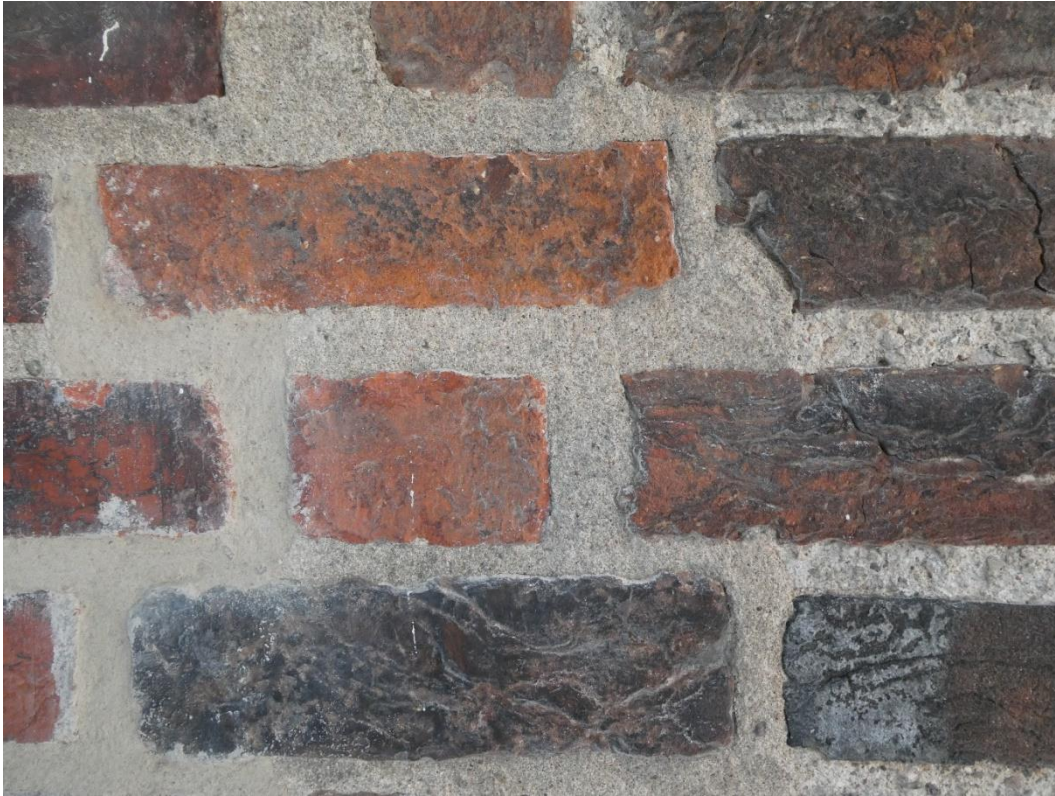
Exempel på ny lagning till vänster i bild, gammal lagning i mitten och till höger äldre vittrad med hållfast fog.
