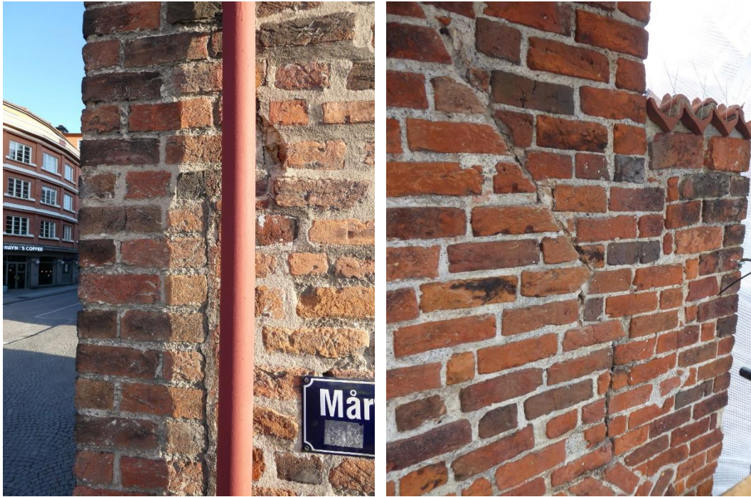
Vänster: Före åtgärder. Sydvästra hörnet, generalskarv bakom stupröret och murparti som kalvar utåt något. Höger: Östra gaveln under arbete.
