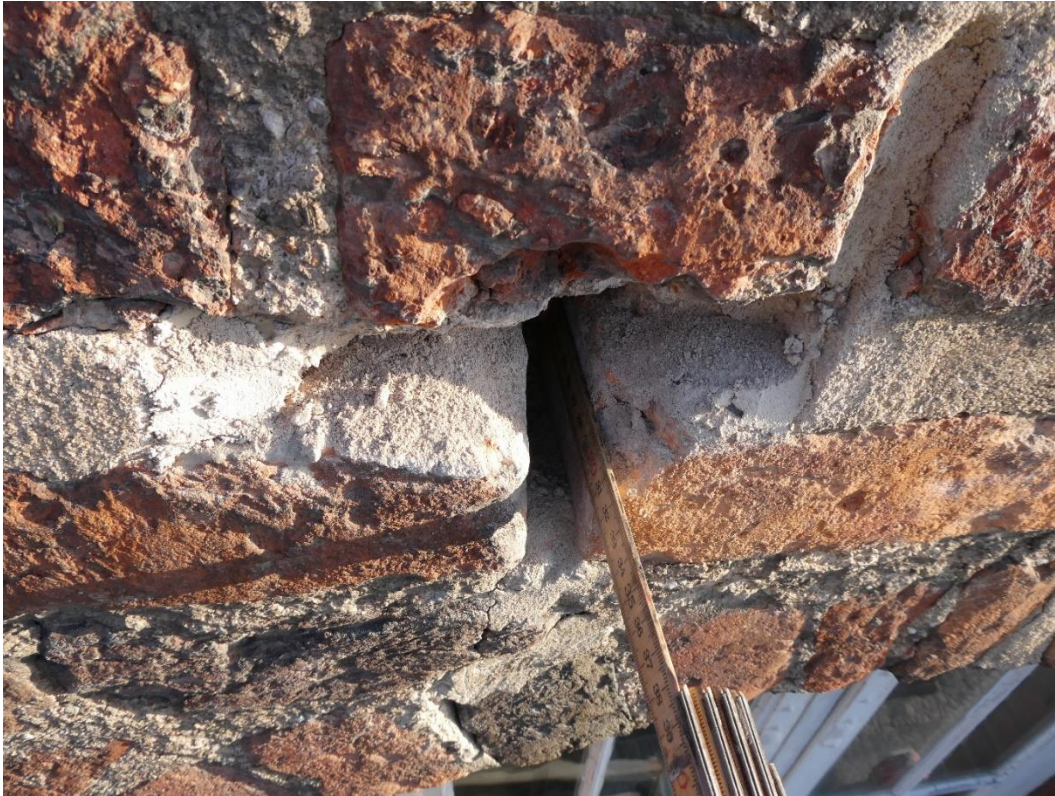
Under arbete. Södra fasaden urlakad fog och murbruk djupt i fasaden.
