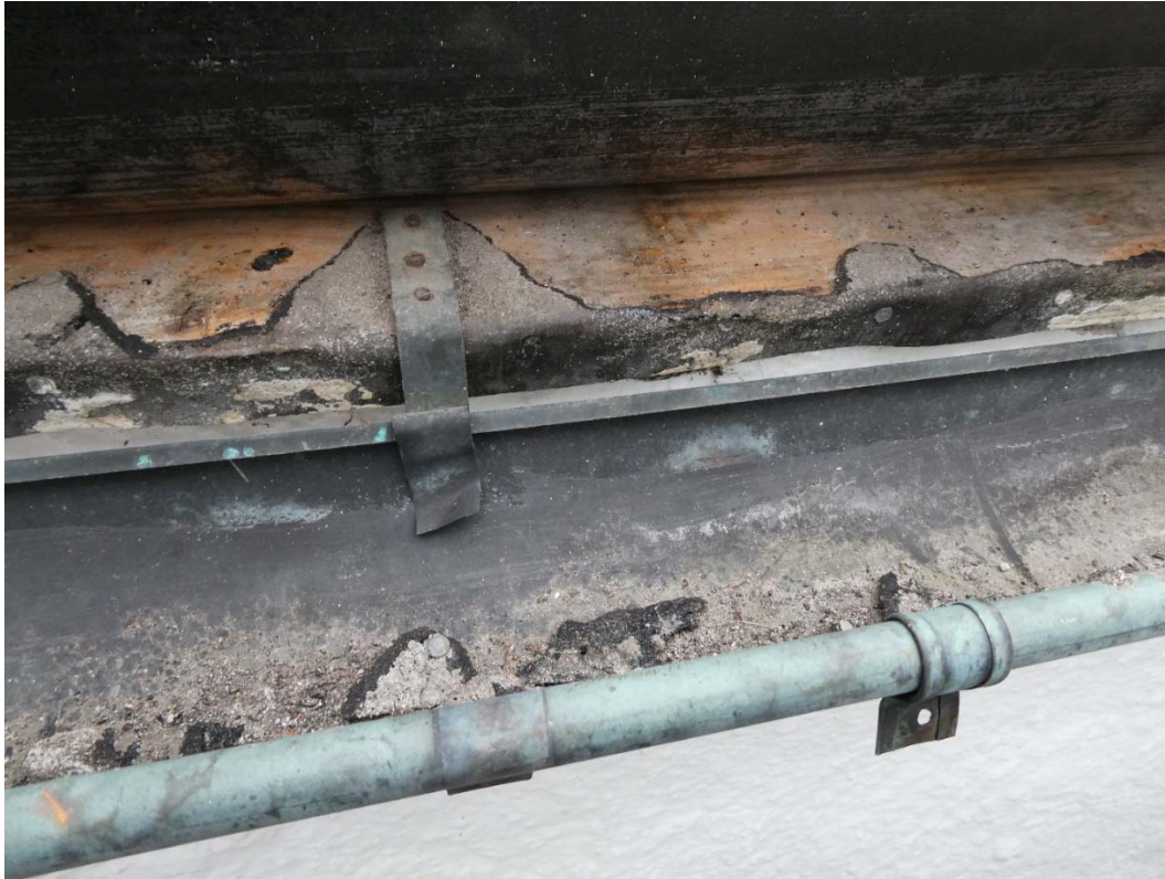
Figur 10. Före åtgärder. Taken saknade fotplåt och hängrännor var underdimensionerade.
