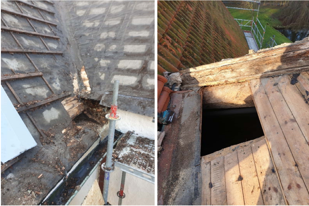
Figur 16-17. Under arbete. Rötskadad råspont vid takfallsmöte mellan västra tillbyggnaden och vapenhuset samt på västra tillbyggnaden
