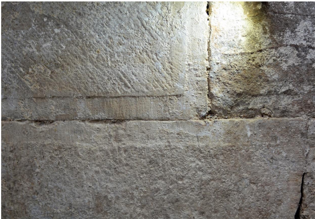
Figur 10. Detaljbild visande den östra fasaden under släpljus. Stenarna är av typen Höörsandsten. Kantslag och diagonal skrädhugning syns tydligt. På den undre stenen kan möjligtvis skönjas spår av bearbetning med spetsmejsel. Foto från öster.
