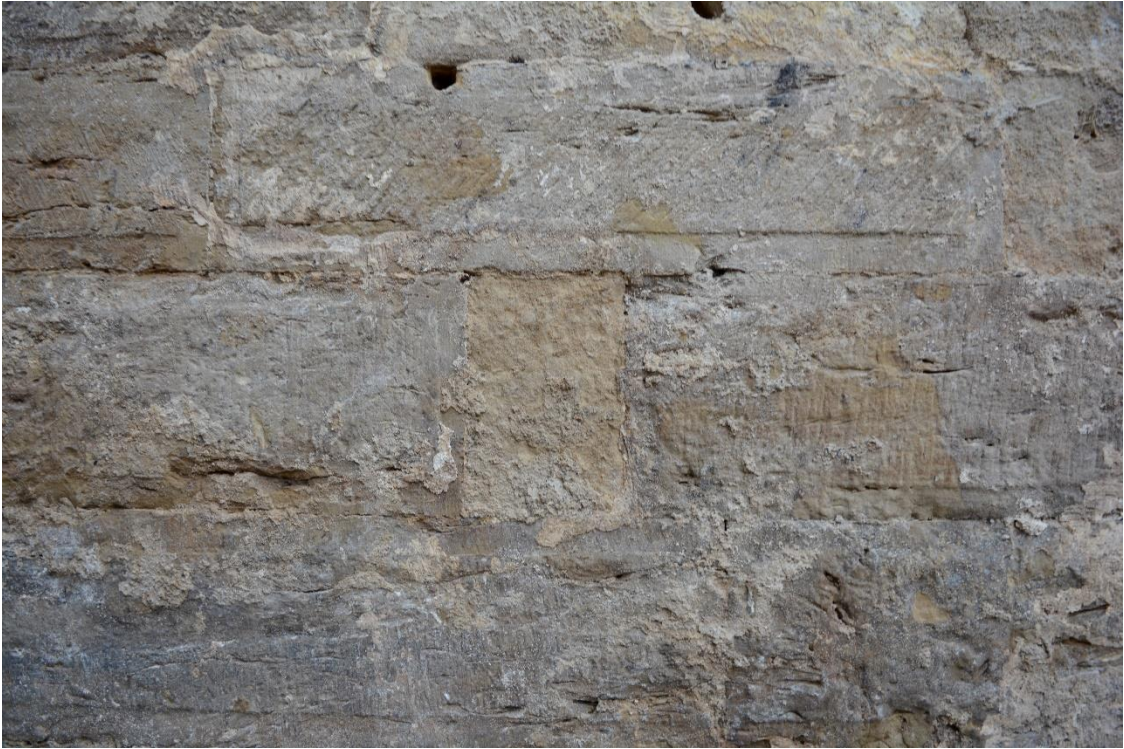
Figur 9. Detaljbild visande den södra fasaden. Stenarna är delvis vittrade och täckta med rester av kalkbruk från stötfogen mot trappan. Stenarna har en höjd på cirka 16 centimeter och har bedömts vara av typen Helsingborgsandsten. På stenarna syns spår av skrädhugning med bredmejsel i form av så väl lodräta som diagonala linjer. Foto från söder.
