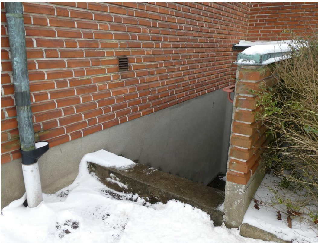
Källartrappa med halvstensmur avtäckd med kopparplåt, en horisontell spricka i murens sockel indikerar rostande armering.
