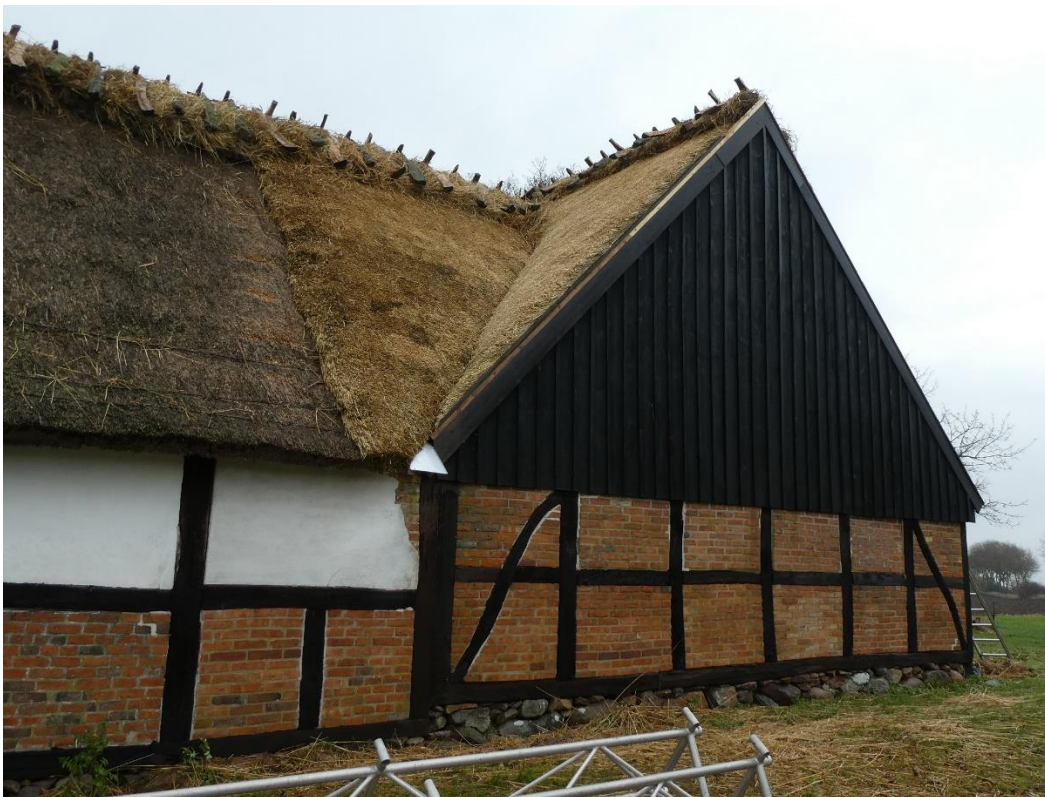
Rännalens plåtning som avviker från traditionellt utförande men skickar ut vattnet från det känsliga partiet, jämför bilden nedan.
