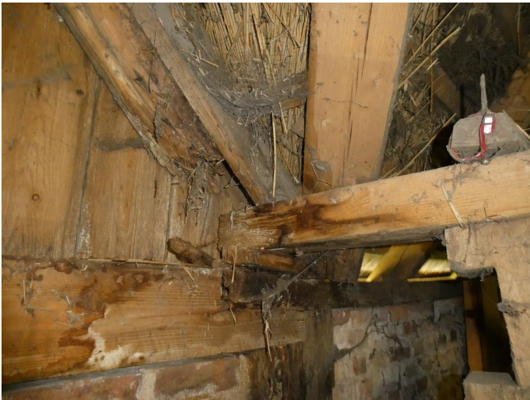
Skadorna i takstolen var gamla, den rötskadade sparren var pålagd med en kraftig fyrkantsregel men pågående läckage i rännalalen förvärrade problemen i lejden.
