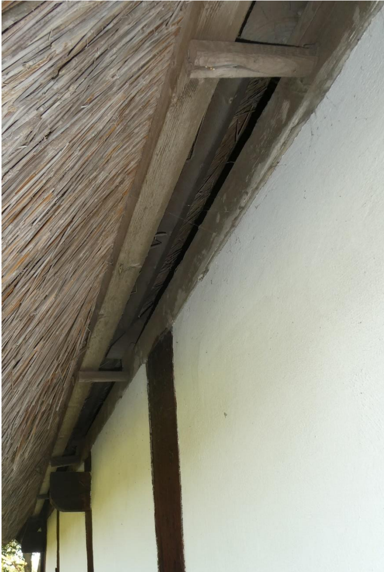
Brädan mot vilket stråna ska spännas i takfoten, kallad avasabor, utfördes 1979 som fyrkantssågad men infäst i lejd med tränaglar på traditionellt vis.
