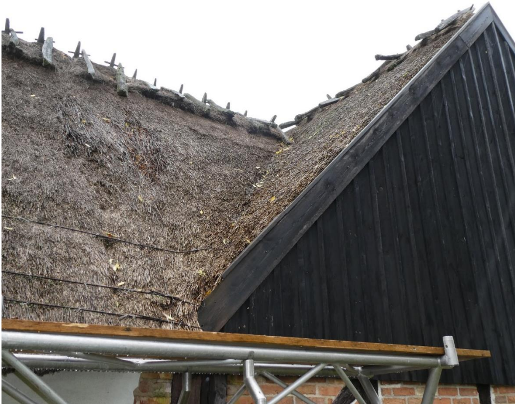
Vid sydsidans rännal letade sig vattnet in innanför vindskivan och orsakade skador i lejden.
