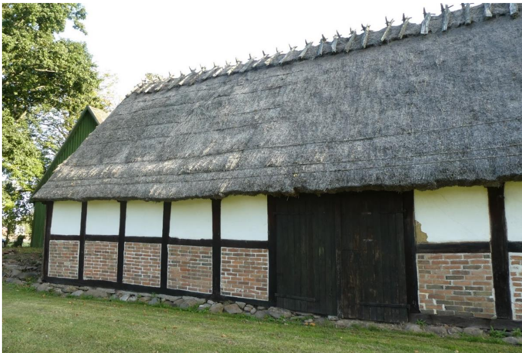
På västra partiet av logens sydsida syntes raften och vassen hade börjat glida ut, även takfoten gled ut och hindrade öppning av portarna. Raften som använts 1979 har varit av armeringsjärn men skiftades till traditionella hasselkäppar 2020. T h syns putsbortfall som blottlägger lerklinad tavla.
