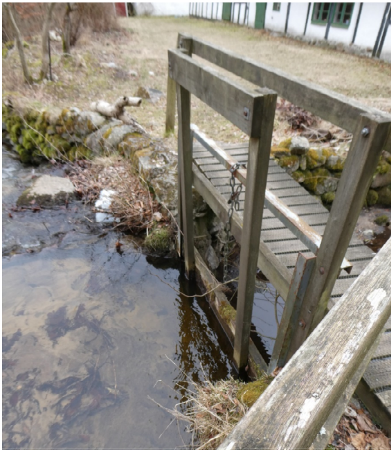
Ovan: by-passluckan. Nedan: tilloppsluckan.
