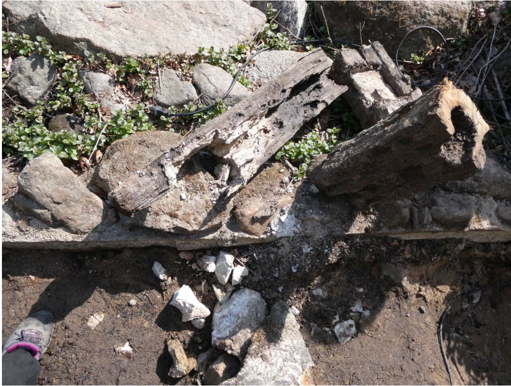
Bjälken som var bottenstycke under tilloppsluckan, den skadade sidan låg neråt.
