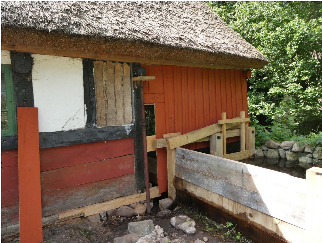
Ny ränna och bytt fotträ mot norr. Två nya panelbrädor (vid fototillfället återstår att montera en bräda).
