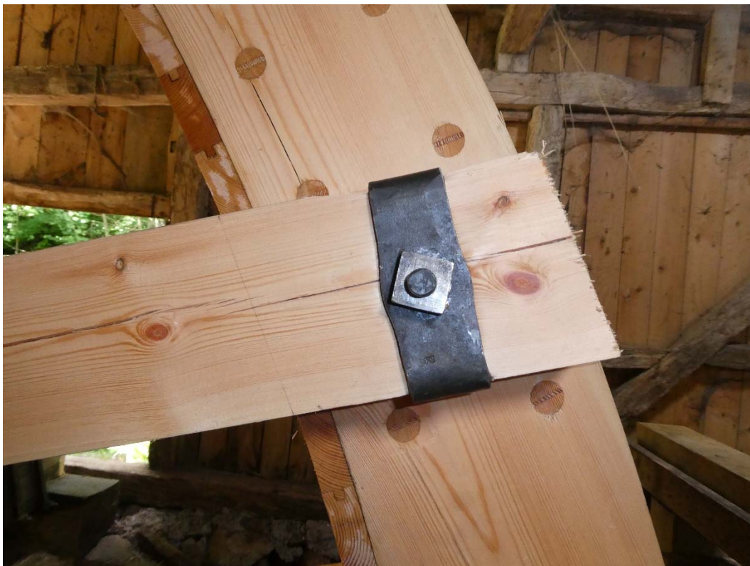
Nytt vattenhjul. Nya brickor med upprymda hål (brickan buktar ur vid hålet).
