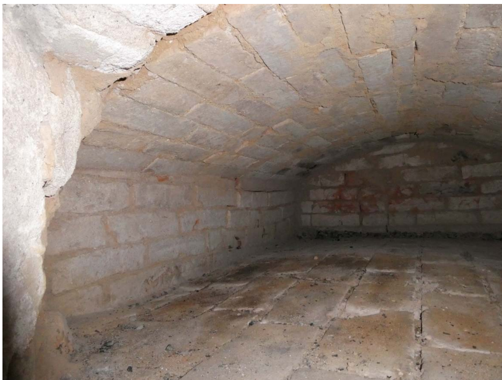
Före åtgärder, bakugnens botten, tak och väggar.
