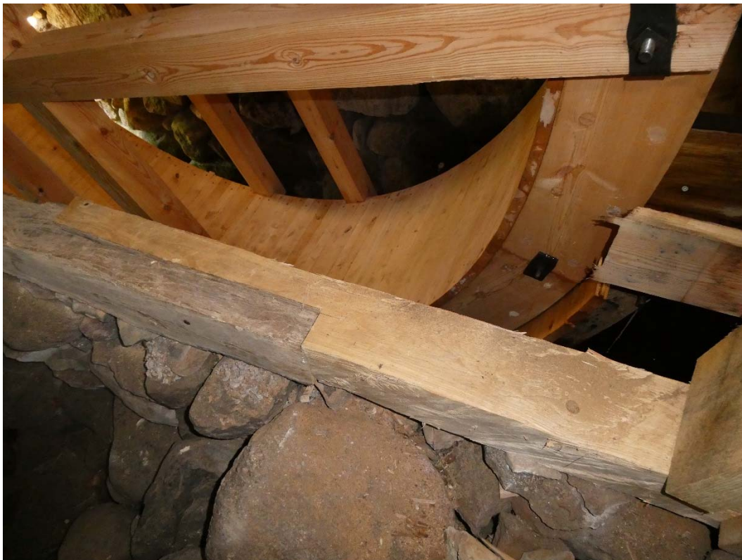
Nytt vattenhjul och invändigt skarvat fotträ i nord-sydlig riktning, samt stolpe till höger i bild.
