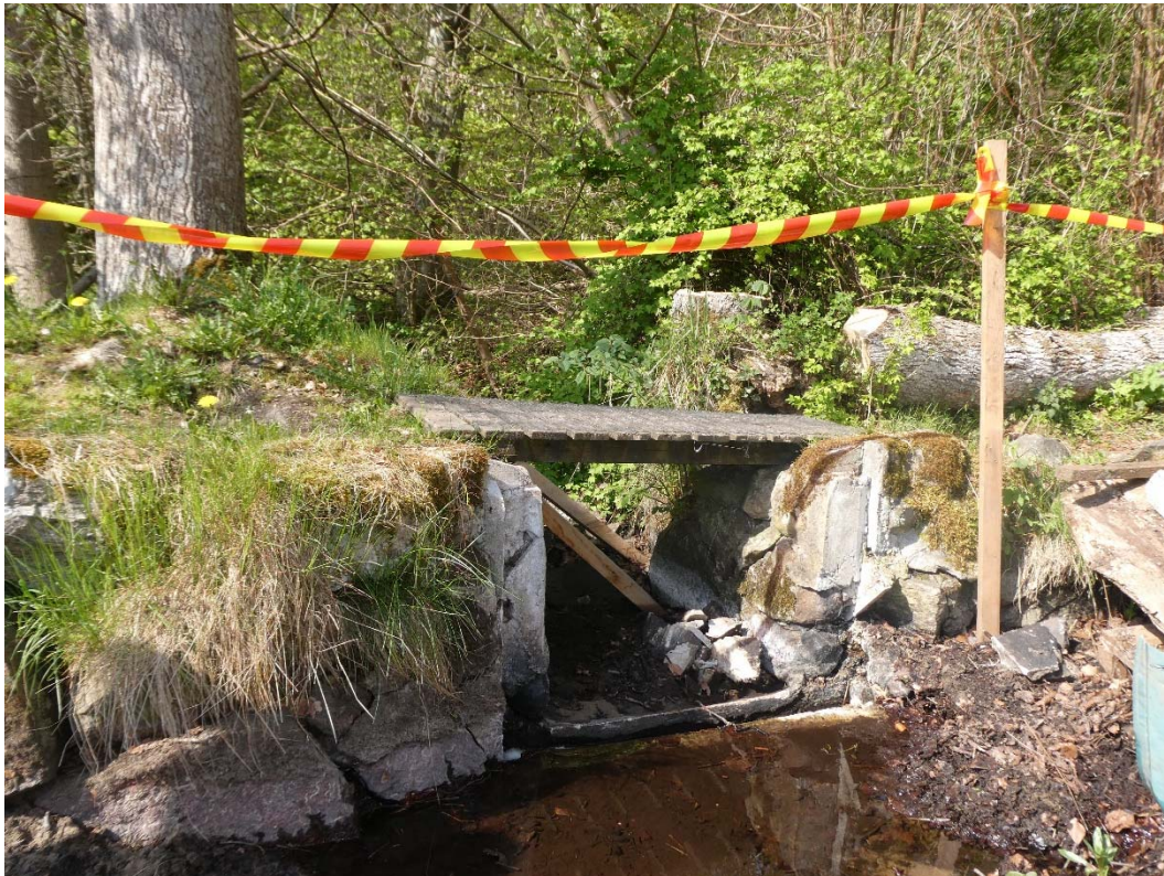
By-pass luckan är bortmonterad.
