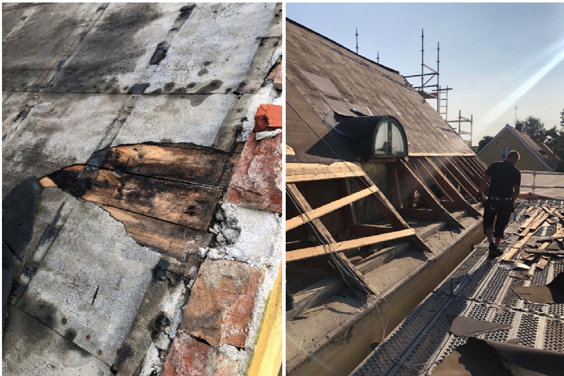
Under arbete. Södra takfallet, råsponten var rötskadad, partiellt bristfällig murning i gavel.
