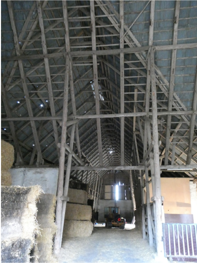
Före åtgärder. Östra vinkellängan, vy mot öster. Notera de många små hålen i den gamla plåten.
