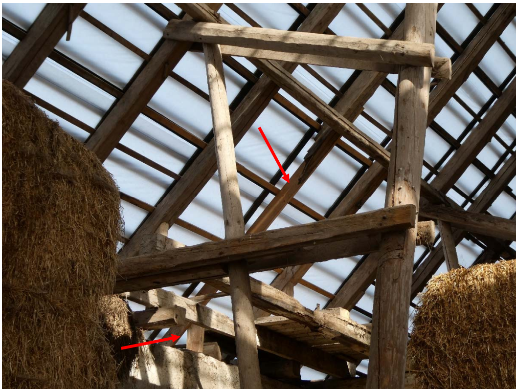
Under arbete. Nord-sydliga längan, exempel på virkeslagningar och förstärkning taklag mot väster.
