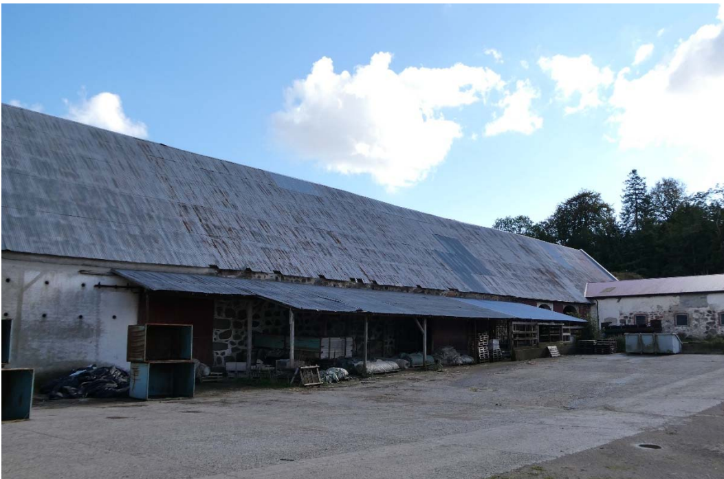
Före åtgärder. Logens västra takfall och skärmtak. Till höger i bild skymtas den före detta materialboden, nu häststall.
