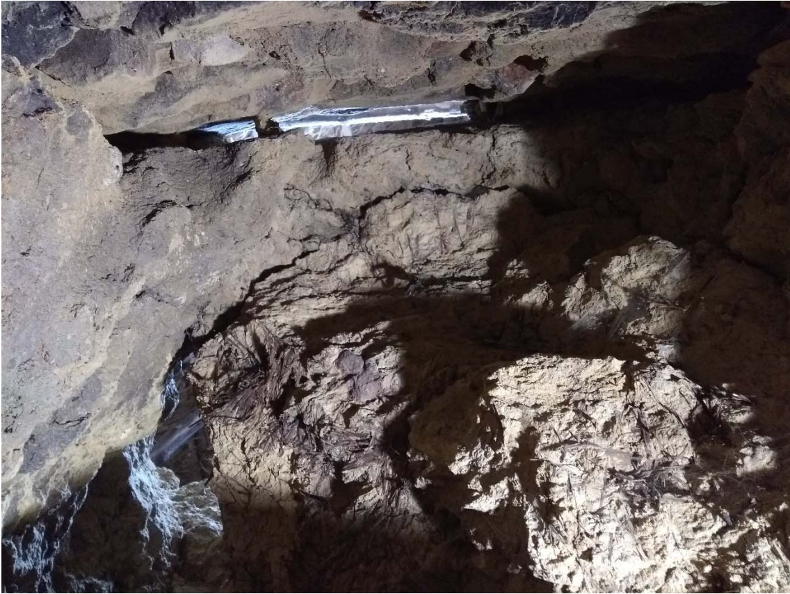
Ugnstaket med håltagningen synlig. Här syns skikten med lera och den intryckta halmen tydligt.
