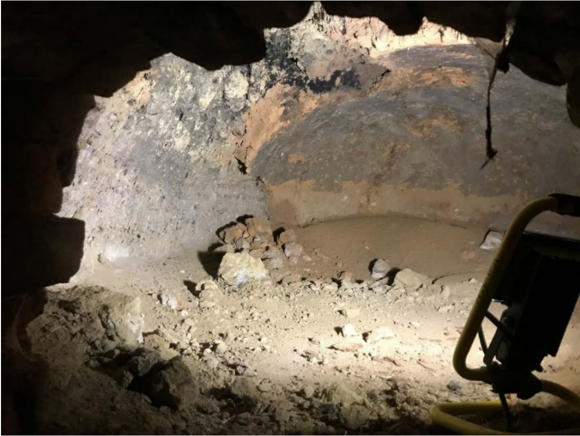
Skador i ugnen med nedrasat material. Den röda leran är spår efter bränningen.
