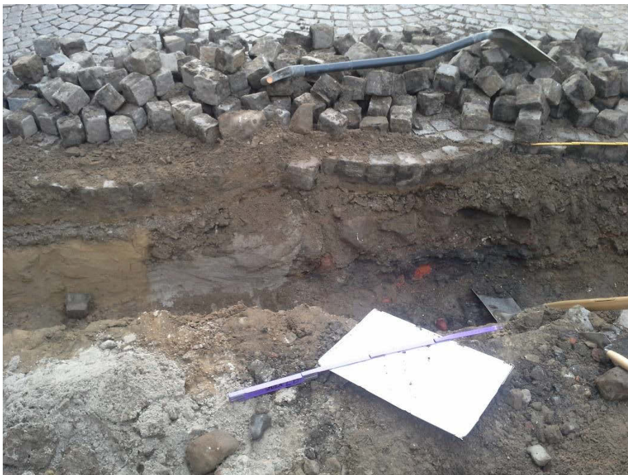
Figur 35. Sektion nr. 1 i Sankt Annegatan, mittersta delen med bland annat lager 10 och 12. Fotografiet taget mot söder.
