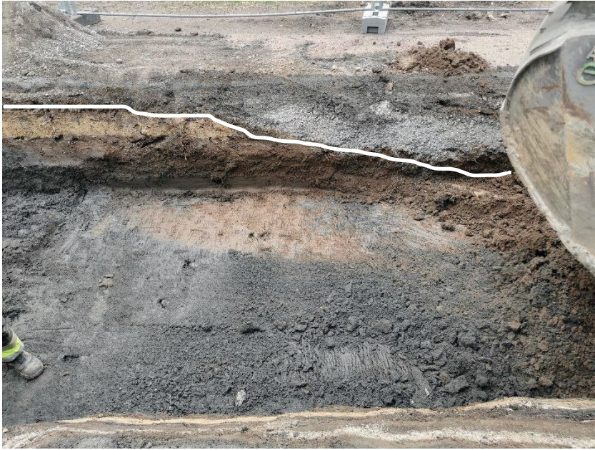
Figur 6. Nedgrävningskanten för dammen, med sin gråa fyllning, syns tydligt mot den gula moränleran.
