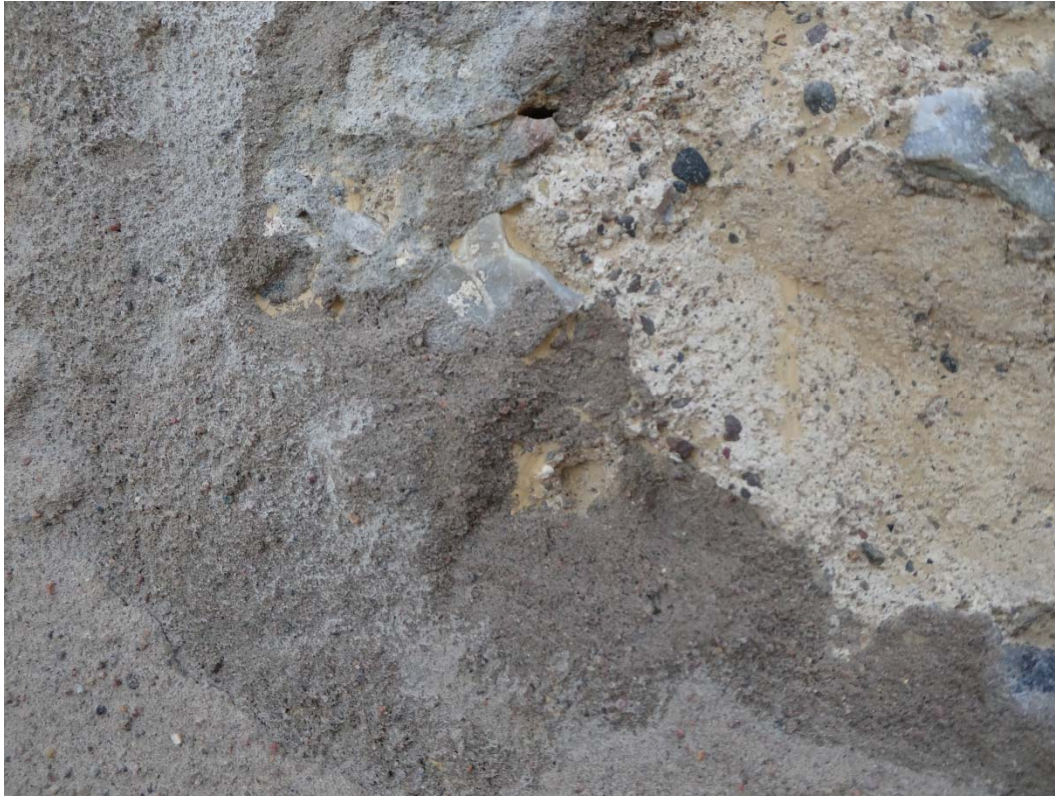
Underliggande bevarade putsskikt med spår av gul färg.
