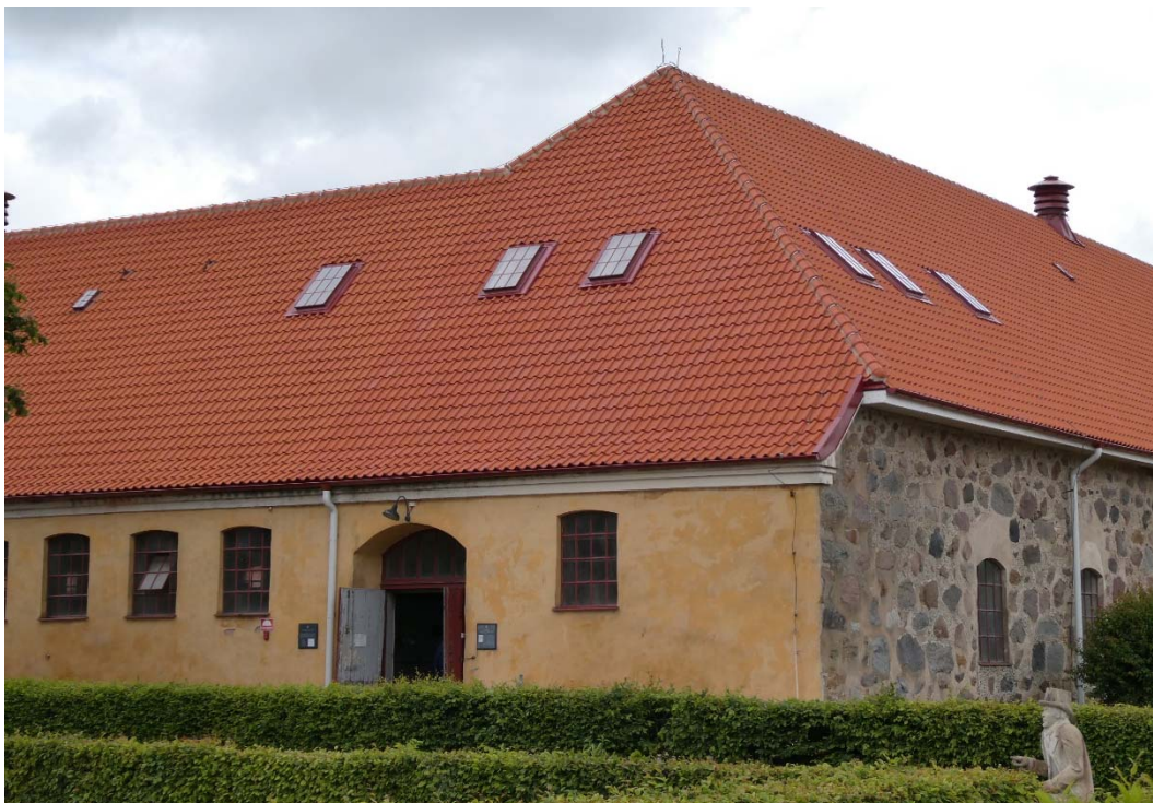
Västra fasaden före åtgärder. (Naturstensfasaden till höger i bild är inte aktuell fasad).
