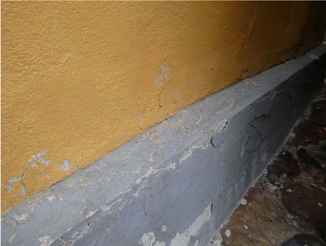
Sockel och fasadparit på Stora hingststallets östra fasad. Färg- och putsskikt lossnar, foto 2021-12-13.
