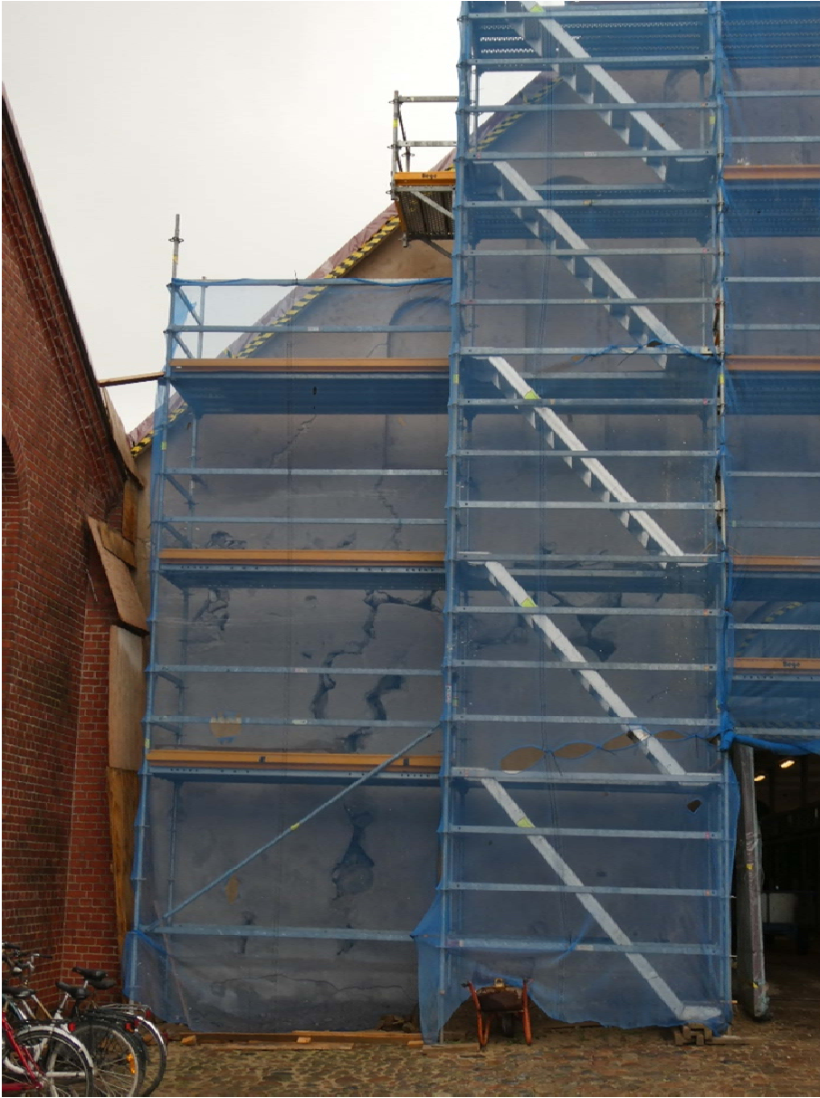
Under arbete, sprickor lagas.
