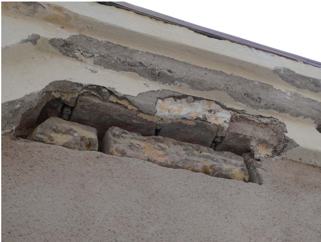
Takfotslist, det verkar finnas underliggande puts som är gulmålad.
