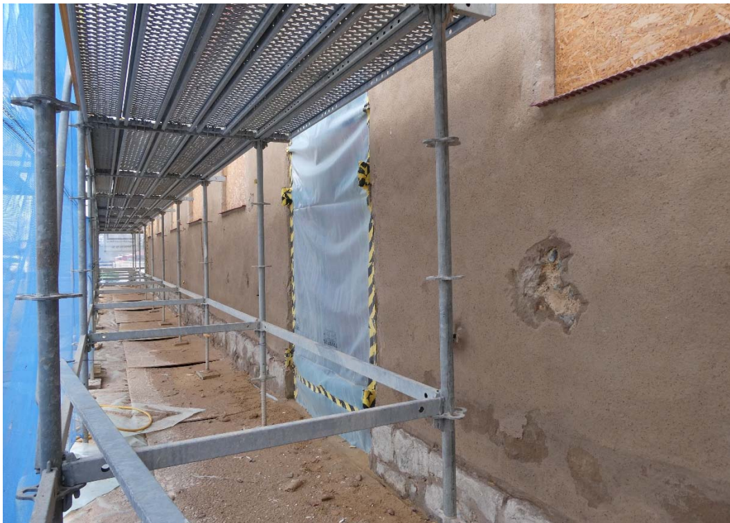
Sockelputsen är nedknackad och stenarna kragar bitvis ut något från fasaden. Fasaden är blästrad.
