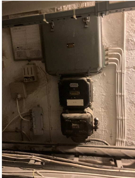
Sentida installationer i källaren och exempel på äldre bevarad utrustning.
