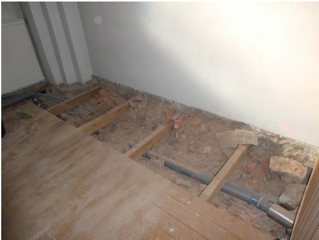
Under arbete. Ny rördragning för vatten, avlopp och el under golvet. På bilderna ses rummet för det nya pentryt söder om korridoren.
