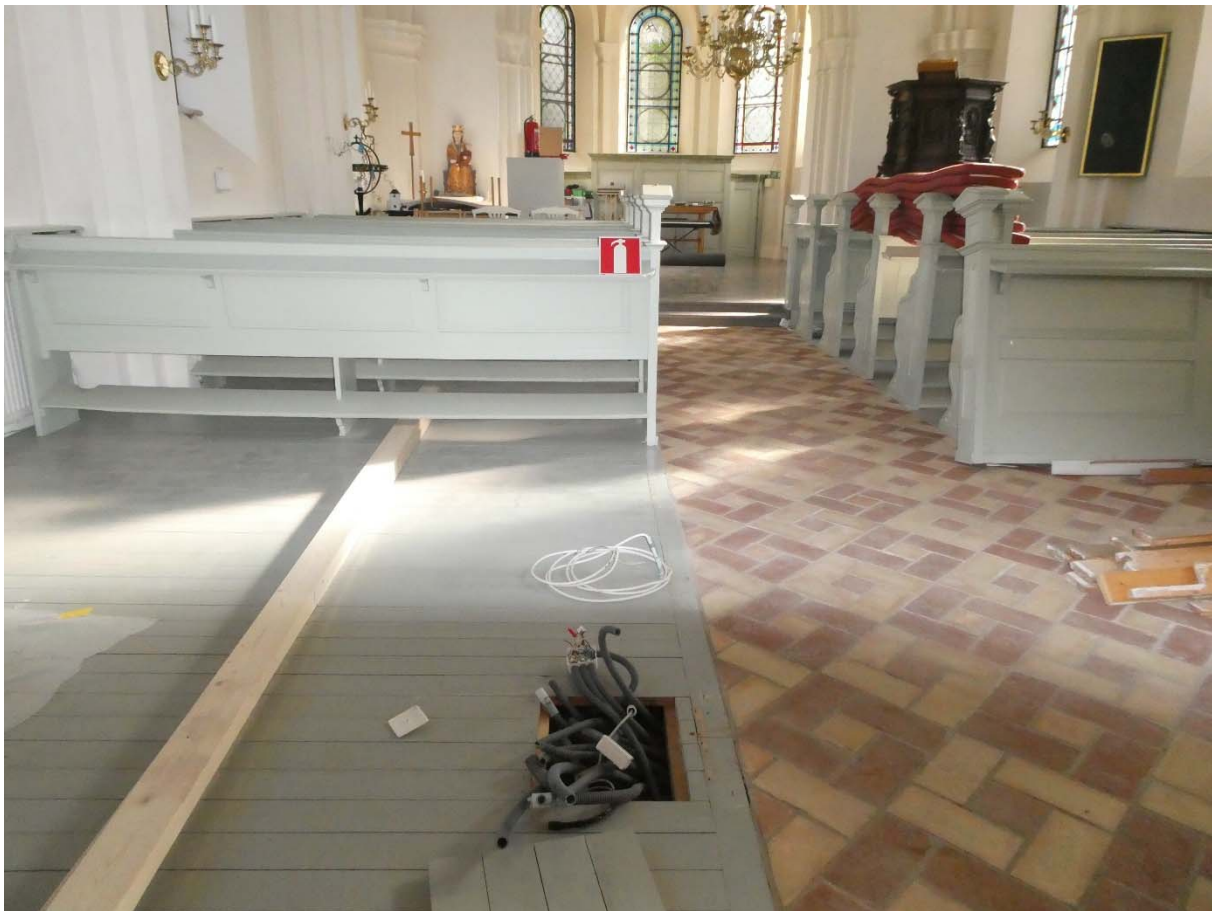
Under arbete. Bänkar har tagits bort och el dras om under golvet.
