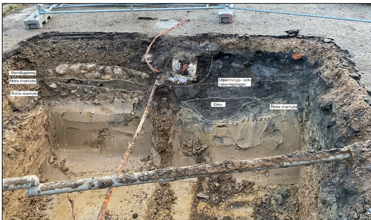
Figur 16. Södra delen av schakt 9. Elledning och dräneringsdike mitt i schaktet. I den västra delen påträffades bland annat omrörda massor, raseringslager samt ett äldre dräneringsdike. I den östra delen av schaktet framkom bland annat en äldre vägbeläggning. Fotografiet taget från norr.
