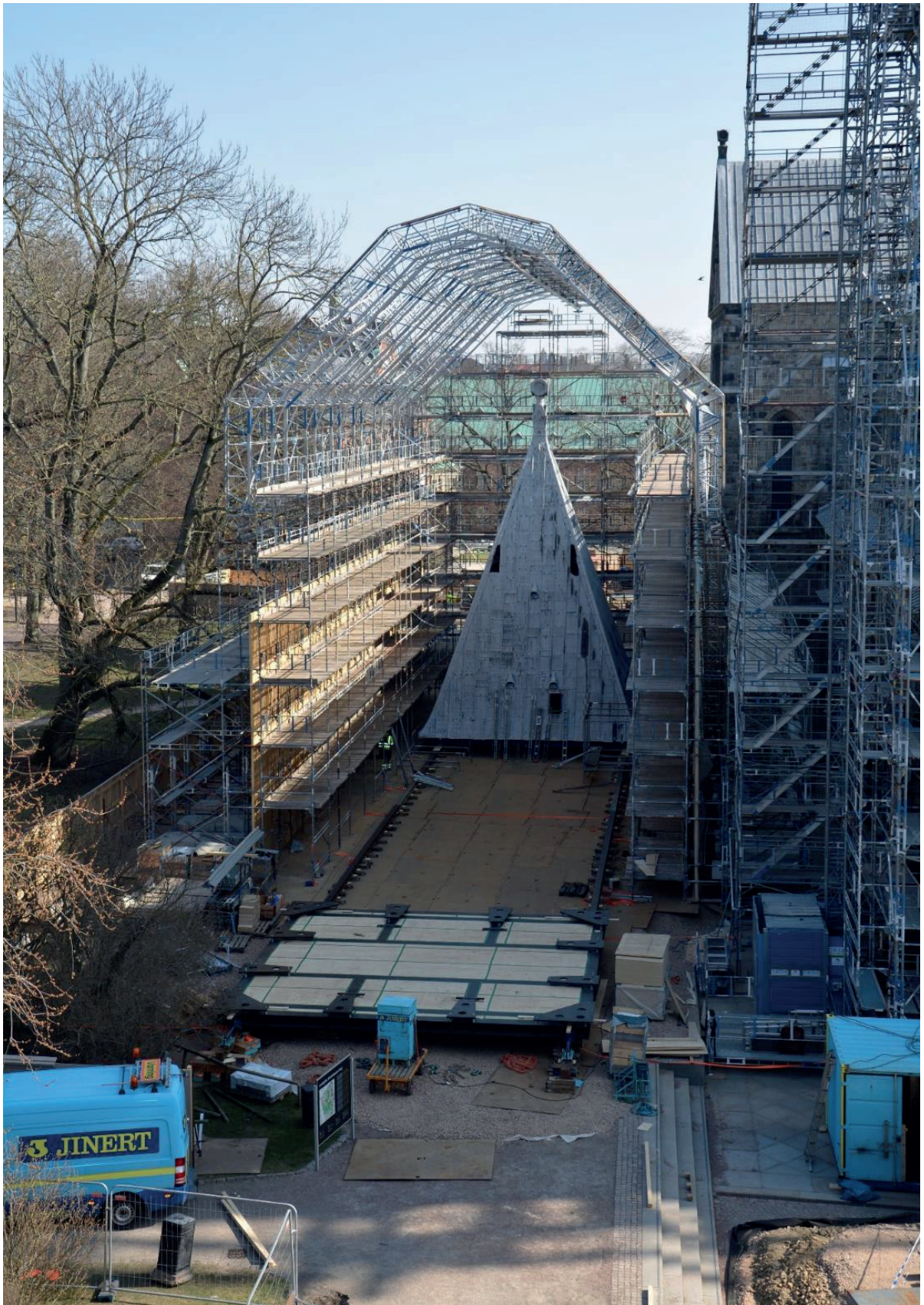
Figur 31. Den norra tornhuvn inne i upplaget, och plattformen för den södra huvn på plats vid rälsen. Fotografi från väster.
