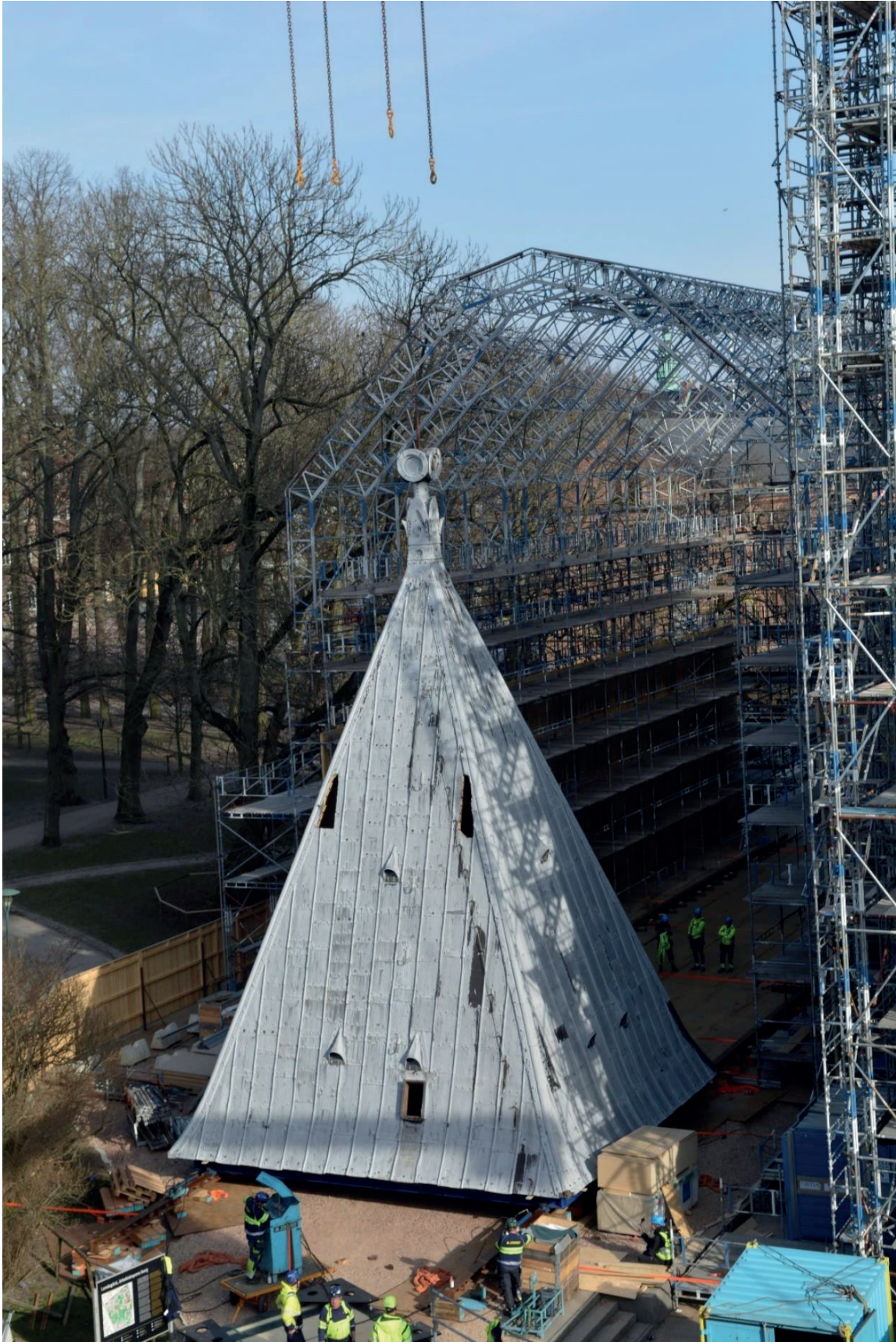
Figur 28. Fästanordningarna har lossats. Fotografi från väster.
