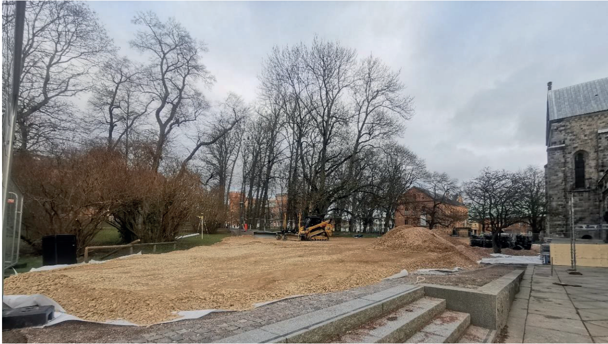
Figur 13. Nordväst om arbetsområdet, utanför sökt yta, påfördes geotextil och bärlager. Fotografi från väster.
