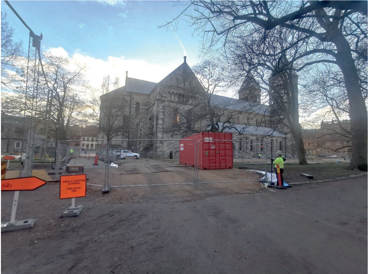
Figur 5. Avlastningsområdet norr om domkyrkan där inkommande massor transporterades in på lastbilar. Körplåtar placerades på marktäckande geotextil för att undvika körskador. Fotografi från norr.
