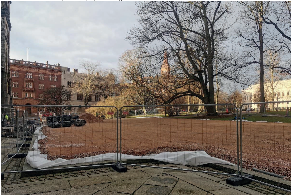
Figur 12. Arbetsområdet norr om domkyrkan, geotextil och däröver bärlager har packats för att bättre fördela lasterna från tornhuvarna som skulle placeras på ytan. Fotografi från söder.
