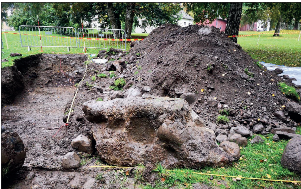
Figur 42. I den östra sektionen i schakt 5 framkom en konstruktion av sten och cement som troligen utgjort en gräns för en ny vattennivå eller ett mindre vattenfall.
