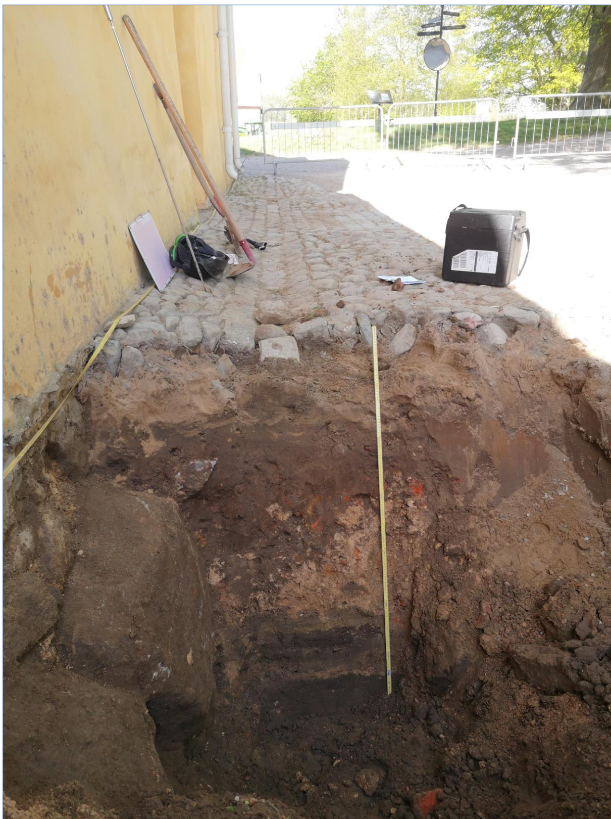
Figur 22. Schakt 2 förlades intill stallets norra fasad. Till vänster i bild skymtar stallets stensockel där två stenskiten avlöser varandra. I sektionsväggen anas även de stratifierade lager som fyllde igen nedgrävningen genom rase-ringslager inför stallets uppförande. Fotografiet taget ifrån öster, år 2024.
