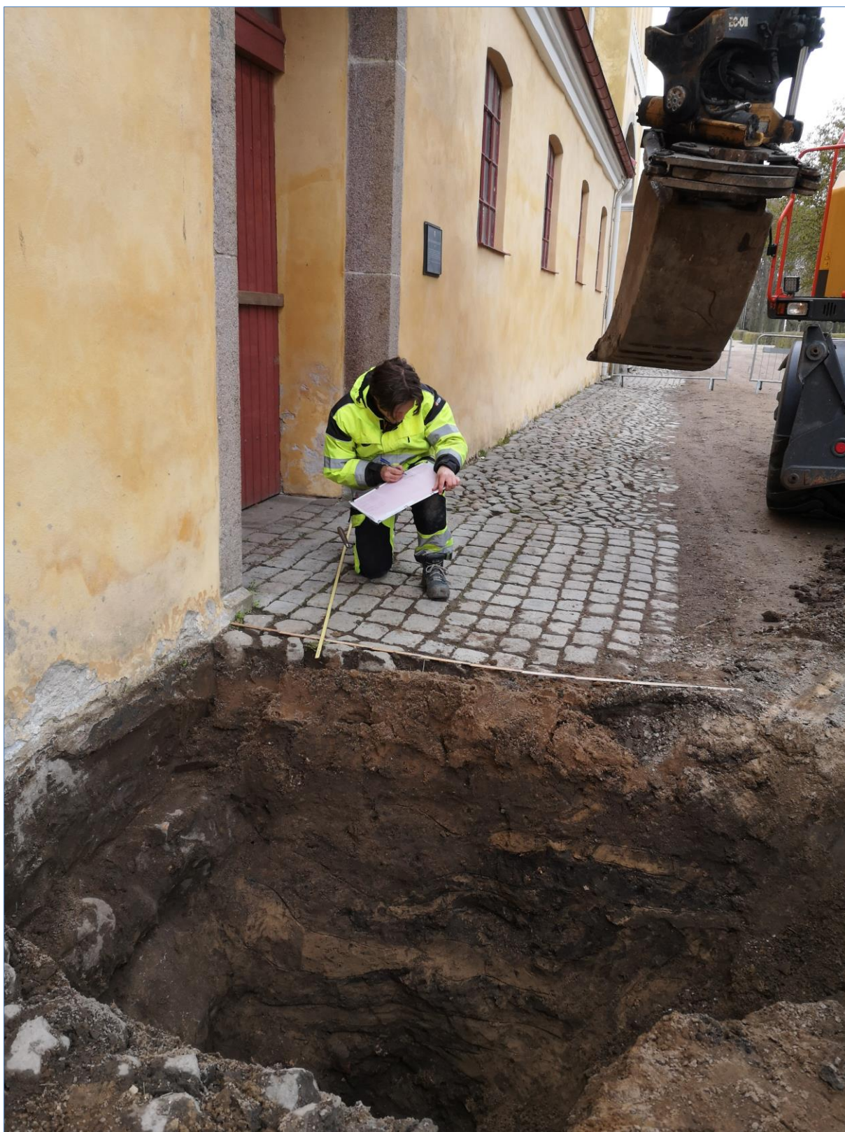
Figur 21. Schakt 1 förlades intill en portöppning i stallets västra länga. Arkeologpraktikant Elias Engdahl dokumenterar schaktet i plan på ritfilm. Till vänster i bild skymtar stallets stensockel där tre stenskiten avlöser varandra. I sektionväggen anas även de stratifierade lager som fyllde igen nedgrävningen inför stallets uppförande. Fotografiet taget ifrån norr, år 2024.
