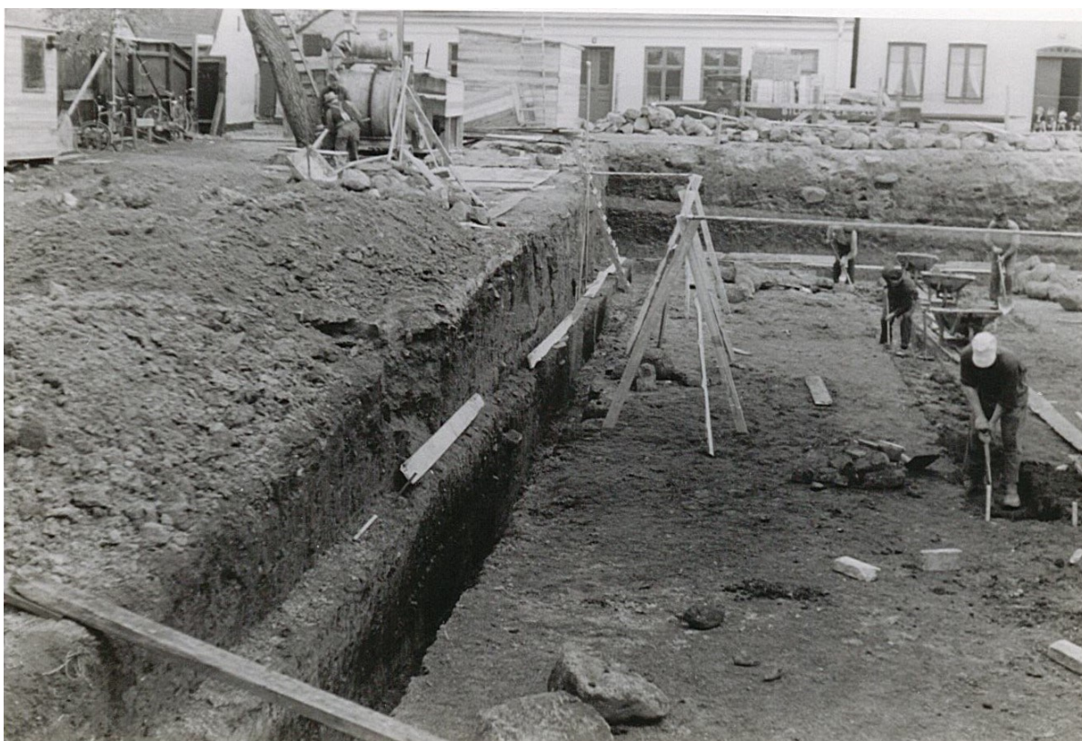
Figur 14. Foto taget från grundgrävningsarbetet den 14 juni 1941, sett från söder. Byggnadsarbetarna handschaktar för grundmurarna till fastigheten. Hämtat från Kulturens LA-arkiv, ref. D.114:26.
