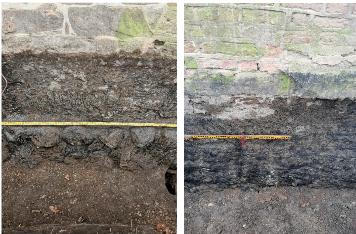
Figur 11. Skillnader i grundmurens uppbyggnad. Till vänster syns en grundmur av natursten, sand- och kalksten, och till höger en grundmur av tegel.
