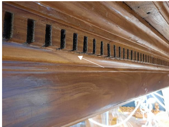
Smuts mellan tandräderna i bjälke vid ventilationsschaktet.
