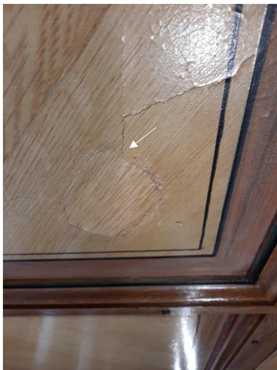
Före åtgärder. Äldre skada som lagats och retuscherats.
