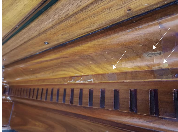
Spjälkning i bjälke. Närmast i bild äldre skador som målats över med ljusbrunt utan kittning.
