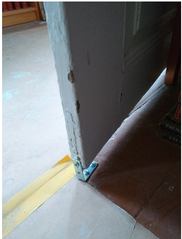
Dörr 12. Tillhöger exempel på bleck på dörr som fixerats i öppet läge.
