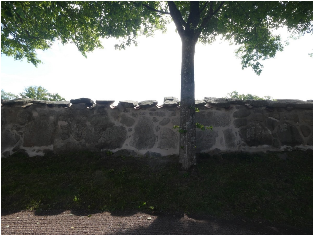
Det södra ommurade partiet.
