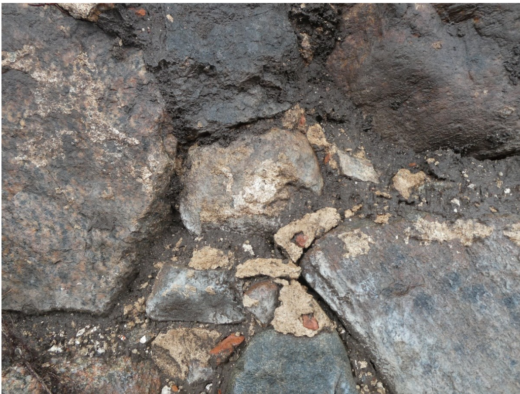
Detaljbilder av murens utsida i norra delen, kalkbruk mellan stenarna syns på den övre bilden, gulaktigt möjligen hydrauliskt kalkbruk och tegelbitar.
