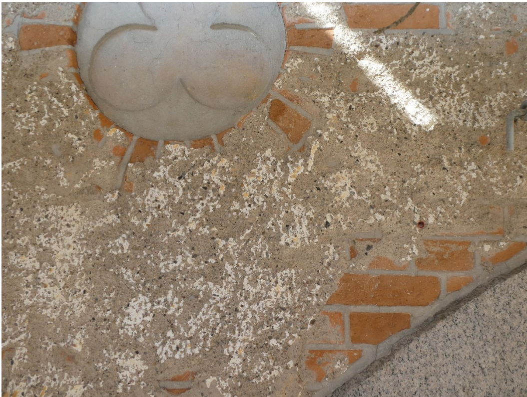
Detaljer östra fasaden. Notera den grå cementhaltiga tegelfogen.
