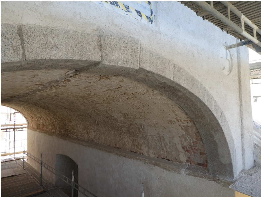
Portvalvet är blåstrat. I mitten finns en gammal lagning med cement. På den nedre bilden syns den framtagna naturstenen i valvöppningen.
