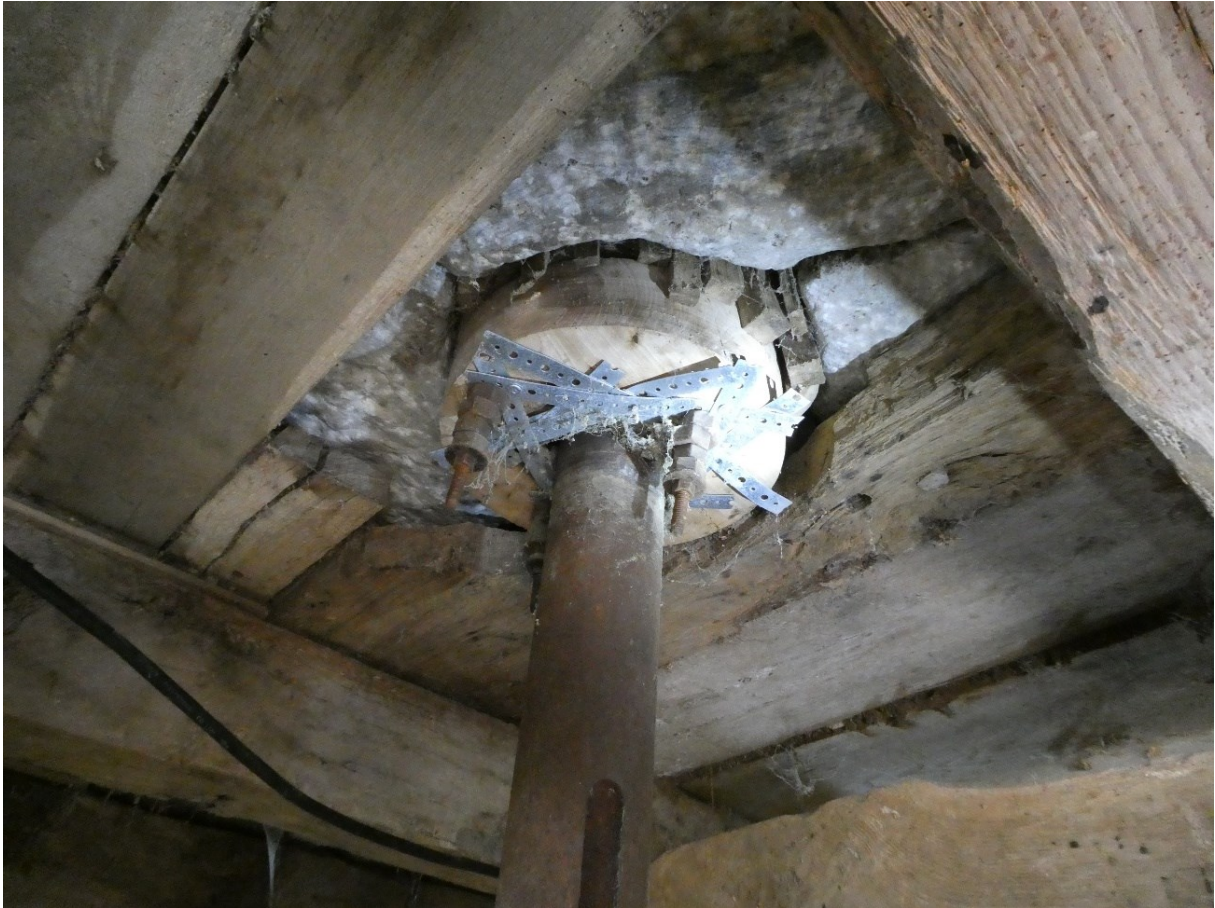
Stenparet som idag är i drift, lager och uppnötta spronsar samt kilar genom liggaren, sett underifrån.
