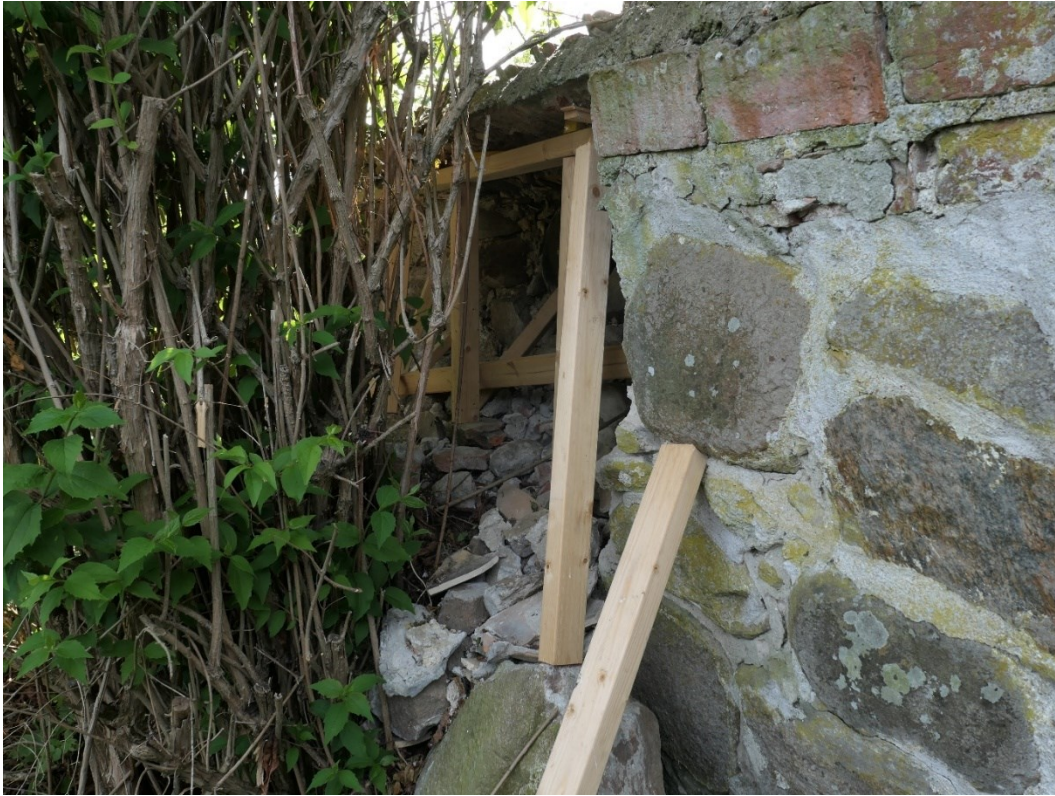
Det aktuella murparitet, utsidan som rasat. Notera tegelstenarna i krönet.
