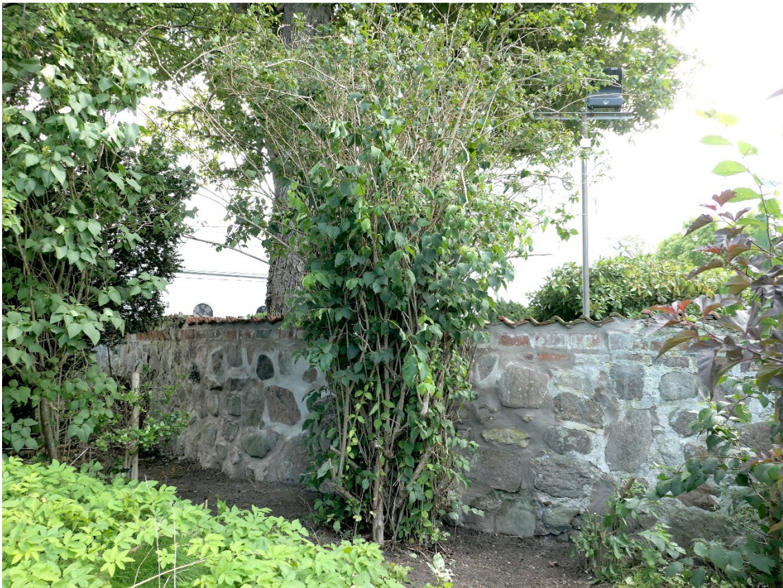
Det aktuella murparitet, utsidan mot grannfastigheten. Fogen var ännu fuktig vid fotograferingstillfället varför den grå färgen på bruket ännu skiftar.
