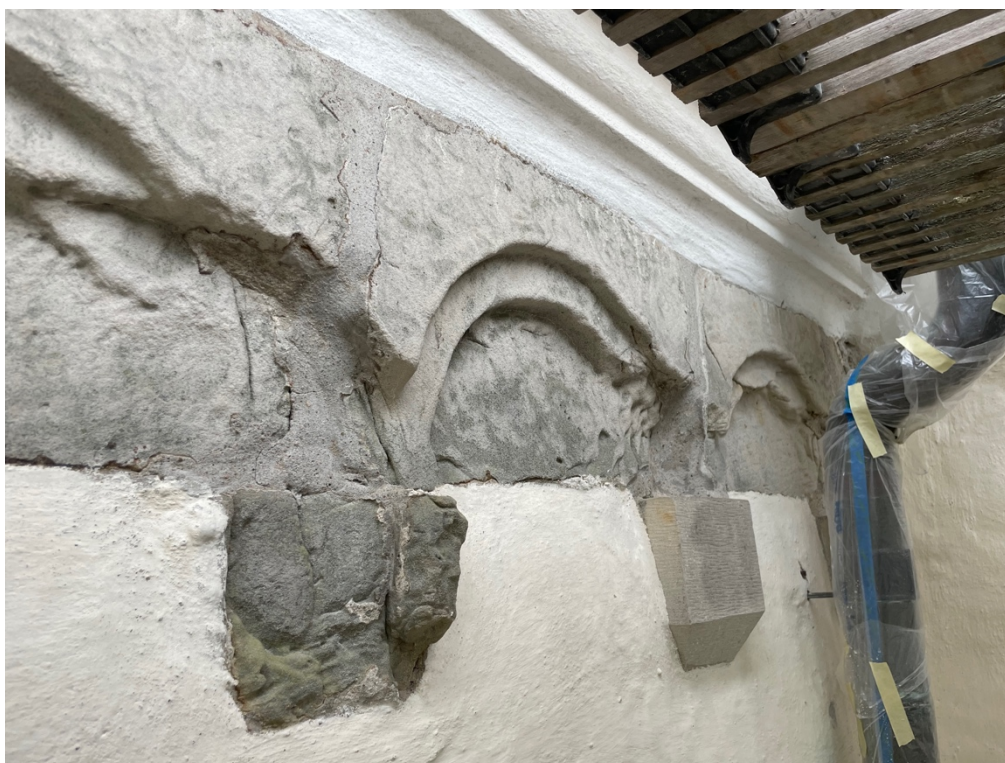
Här ses exempel på avrundade former och förlorade detaljer som inte bör åtgärdas.
