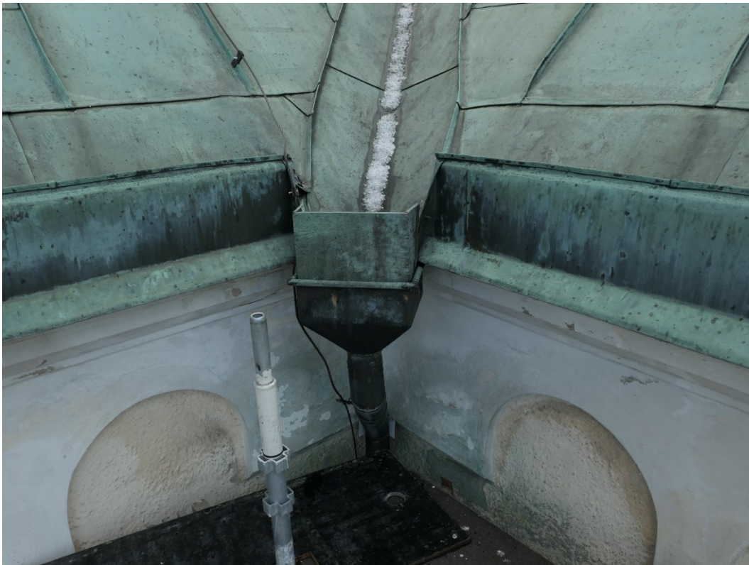
Exempel på plåt och avvattning före åtgärder.
