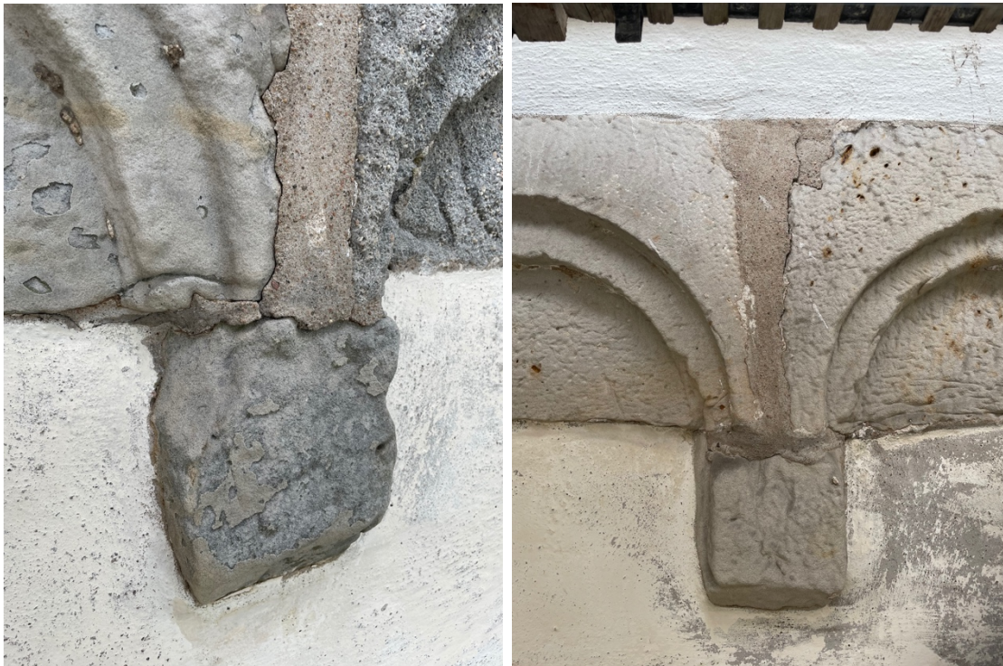
Här ses fogar i cementbruk som släppt från underlaget.
