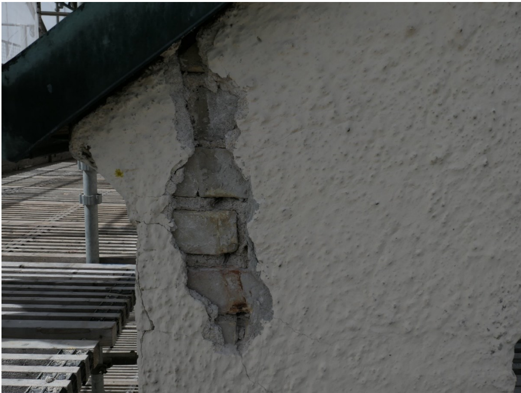
Exempel på skador i tinnar, putsen har knackats ner vid skador och rostande järn tagits bort.
