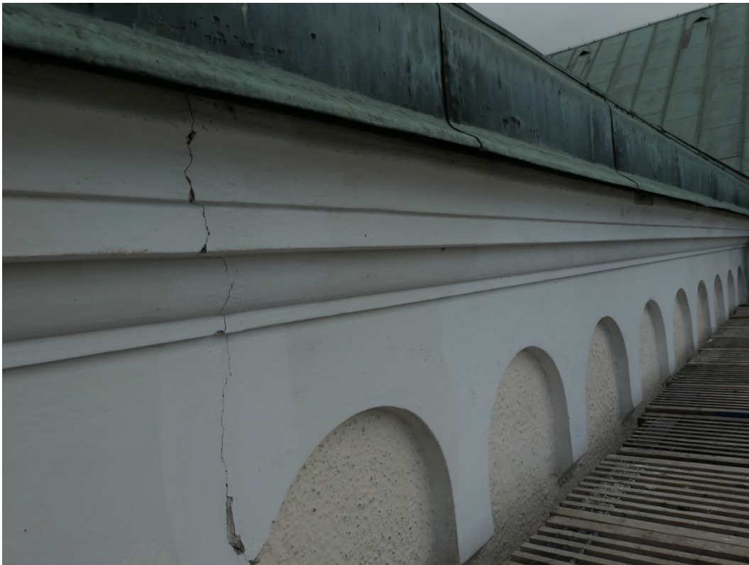
Fotränna och partiell sprickbildning. Långhuset.
