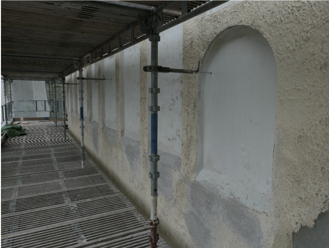
Exempel på putslagningar långhus.
