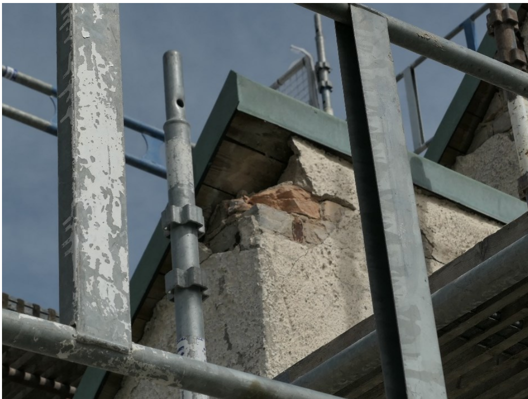
Exempel på skador i tinnar, putsen har knackats ner vid skador och rostande järn tagits bort. Den nedre bilden är norra korsarmen mot väster.
