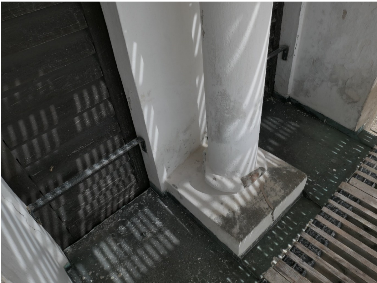
Exempel på skador på pilaster vid tornluckor och efter lagning. Luckor före de målades.
