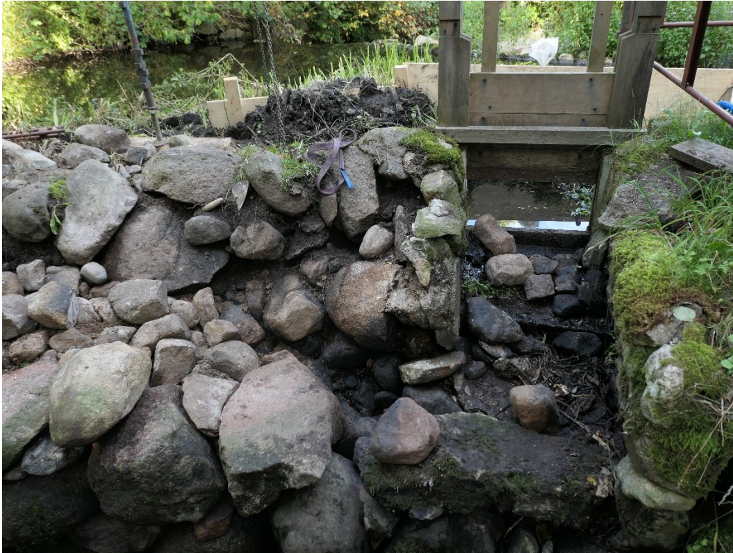
Muren norr om by-passluckan under återuppförande, återstår att ta bort cement vid luckan..
