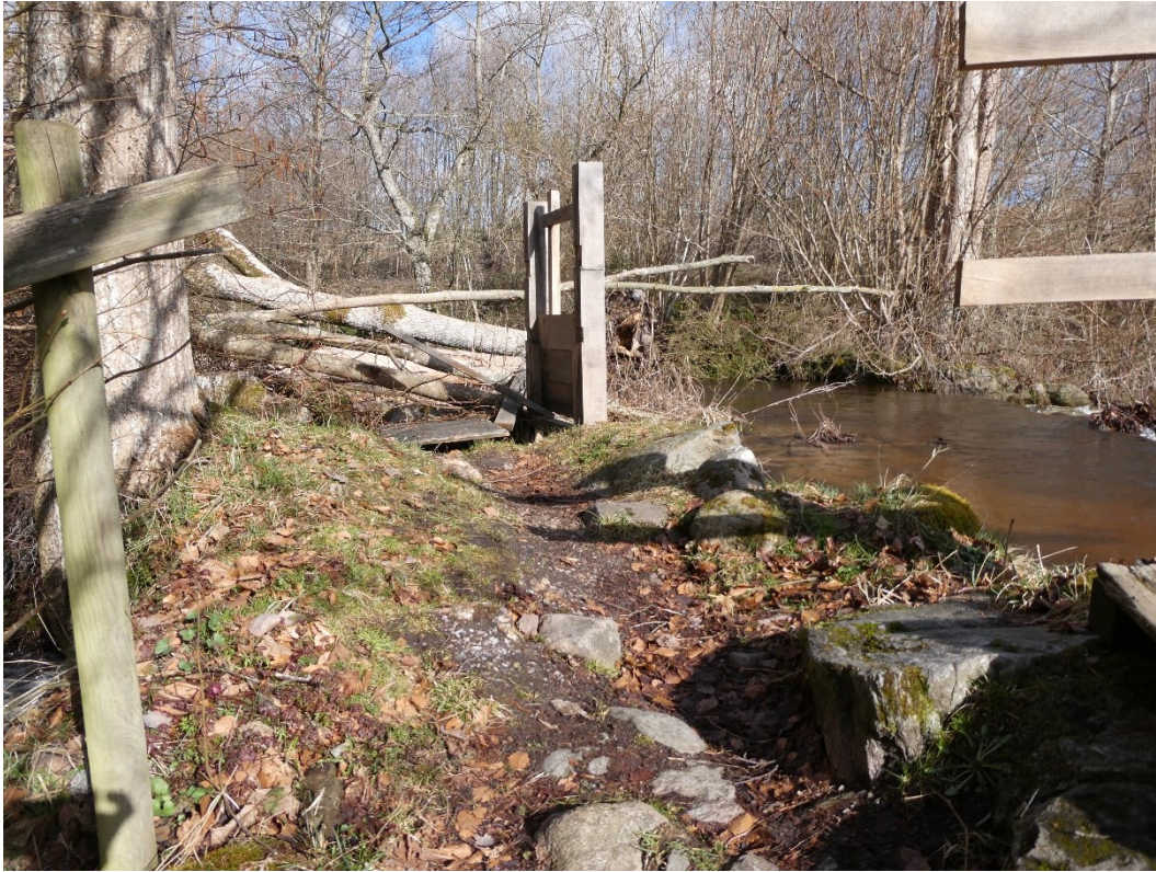
Mitten på dammvallen har sjunkit. Foto april 2022.
