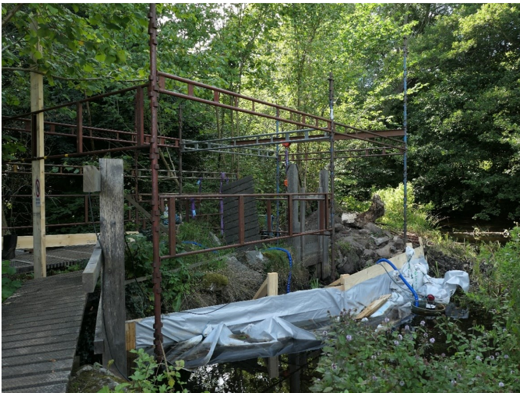
Ställning och provisoriskt dämme under arbetet. Vy mot dammen och dammvallen norr om kvarnen.
