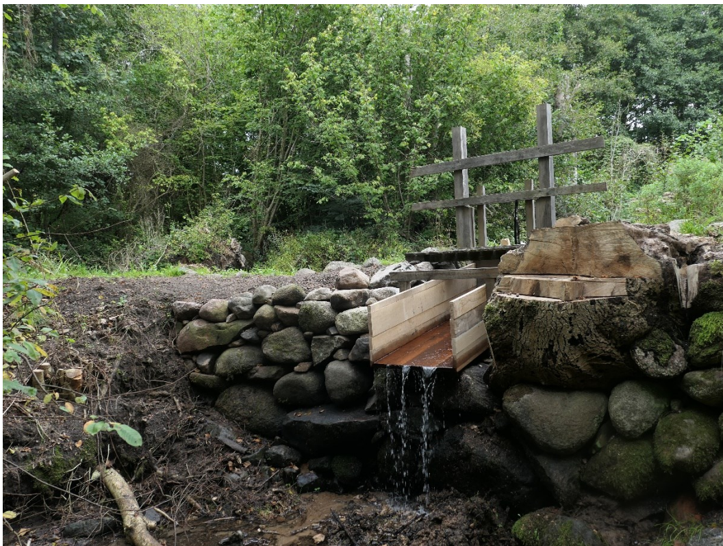
Utsidan som vetter mot väster med brädklädd utskovsränna. Södra stubben till höger i bild.
