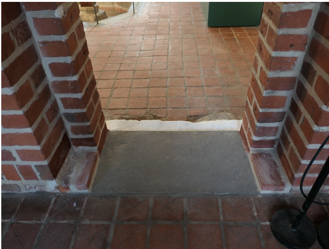
Tröskel har tagits bort mellan korsgången och kapitelsal/utställning och nygjutning på befintligt underlag.
