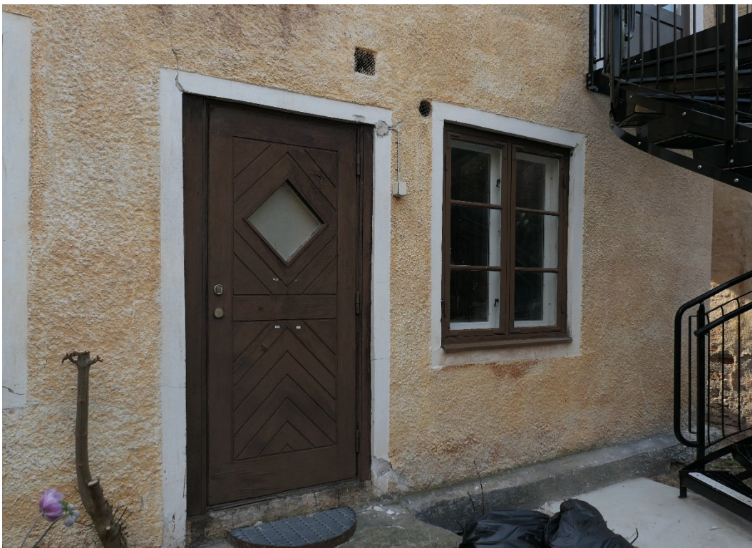
Dörr som invändigt försetts med brandskyddsskiva innanför glaset.
