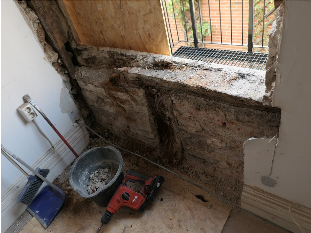
Efter att spräckpanelen tagits bort. Korsvirket i anslutning till fönstret och hörnet var rötskadat.
