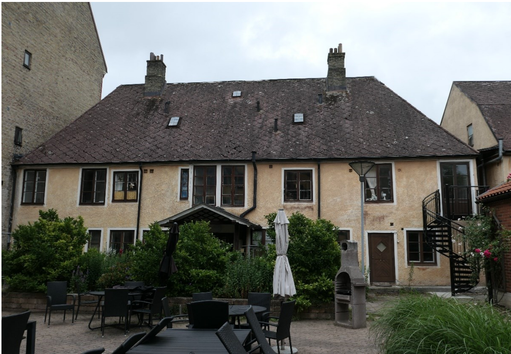
Gårdsfasad. Före och efter åtgärder, ny brandtrappa och utrymningsdörr till höger i bild.
