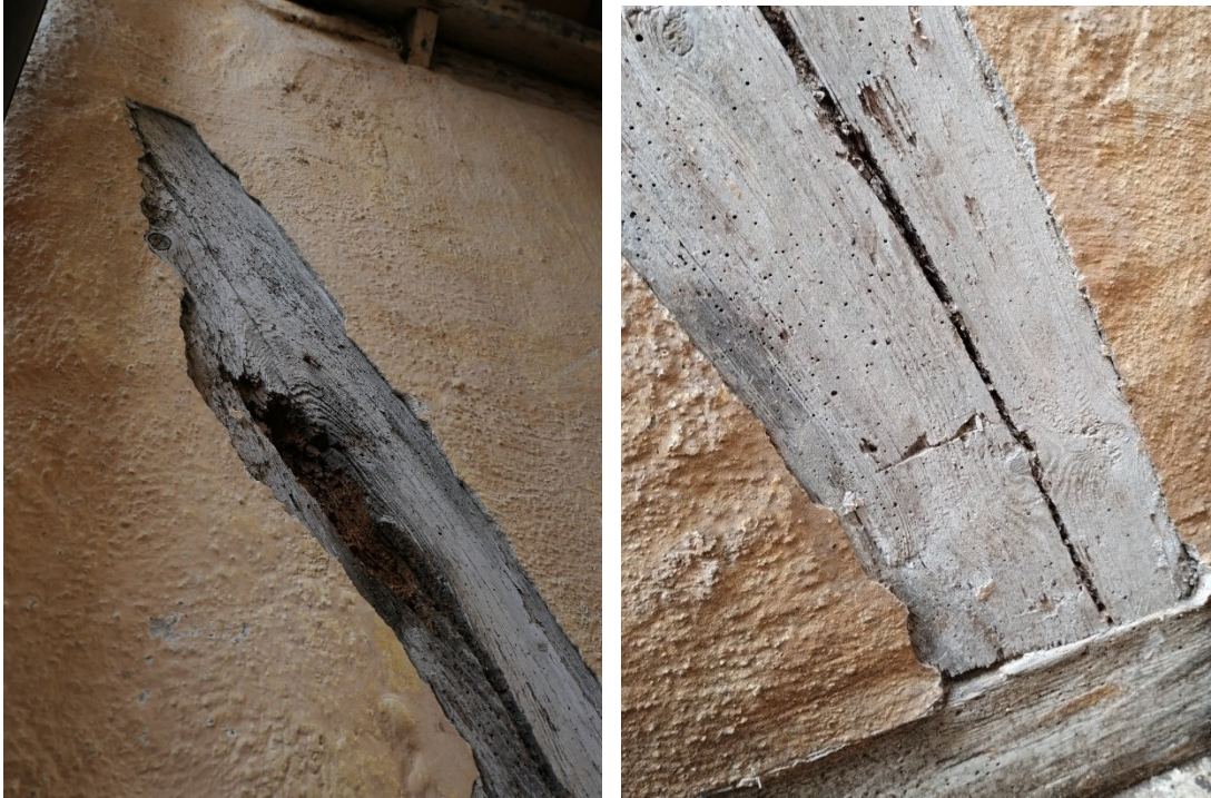
Södra gavelfasaden. Rötskadad snedsträva. Höger: Hantverksmarkering på snedsträvans nedre de som kunde bevarades strax ovan fotträ.
