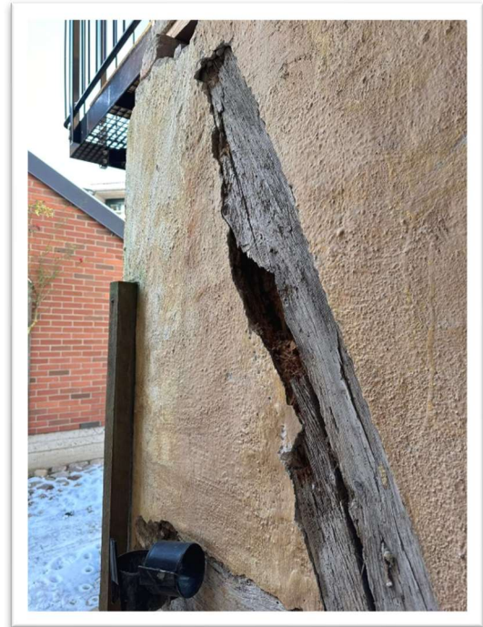
Före. Skadad och flagnad puts mot skadat korsvirke.
