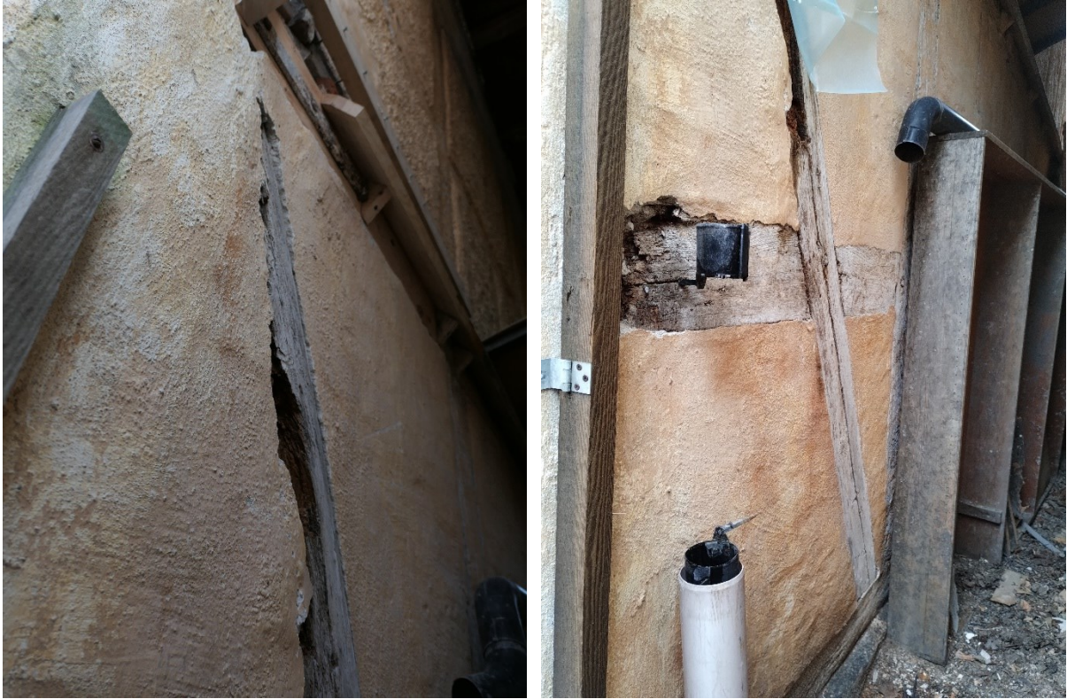
Före åtgärder, snedsträva rötskadad ovan löshulten.
