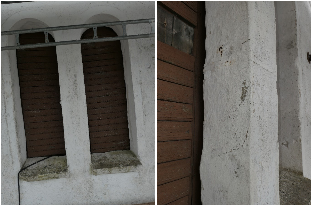
Före åtgärder. Exempel på ljudluckor och järn som orsakat spricka i murpelare mellan luckor.
