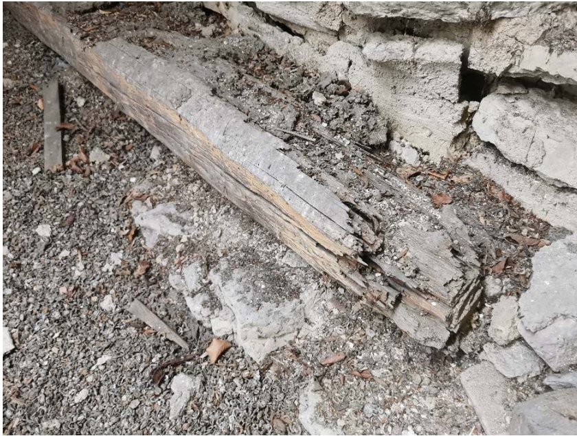
Figur 12. Bilden är tagen innan städningen från sydväst och visar kyrkvindens sydöstra hörn i område Ö1 (jämför figur 15). På bilden syns århundraden av torkad fågelspillning och den södra änden av kyrkvindens östligaste remstycke. Som synes är remstycket i väldigt dåligt skick.
