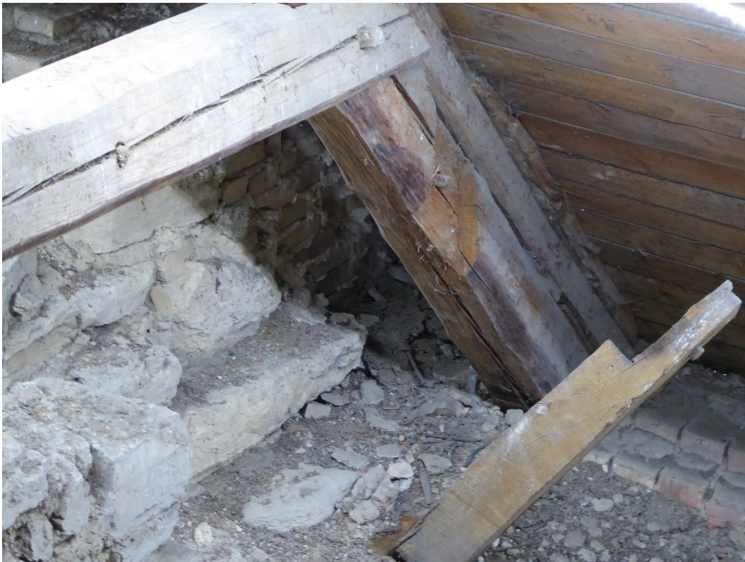
Exempel på skador före vindsstädning och före åtgärder.
