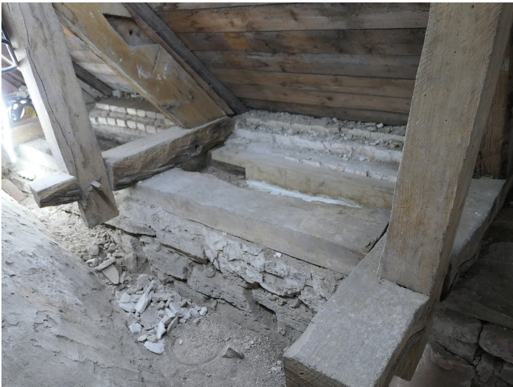
Södra yttre lejden partiellt rötskadad. Före och efter åtgärder.
