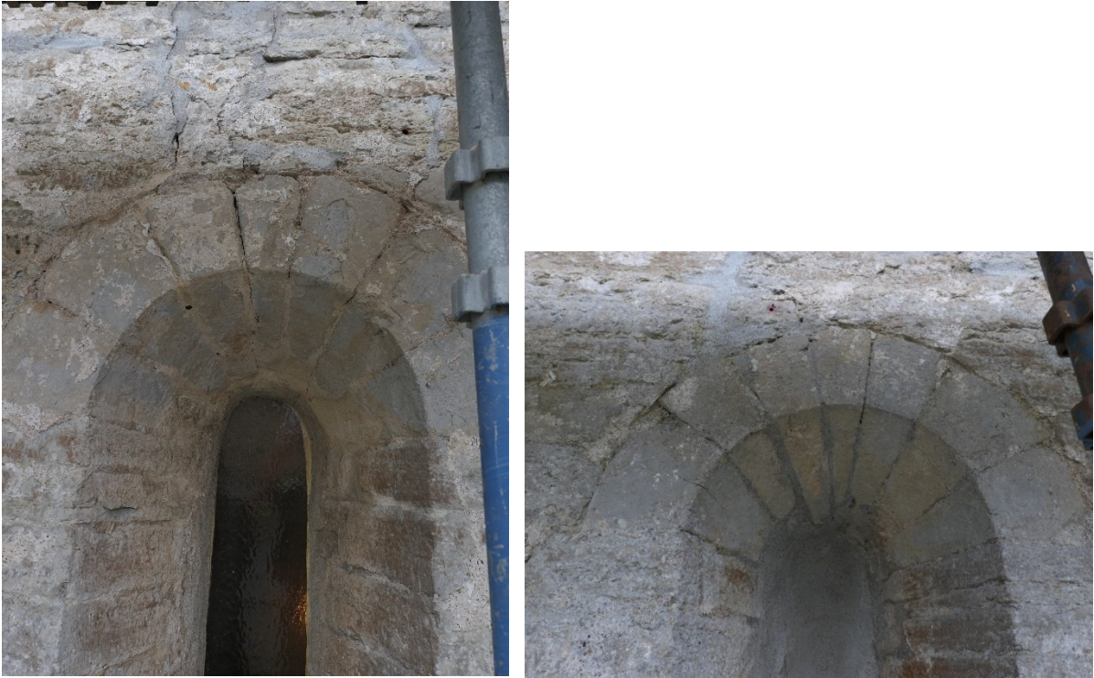
Före åtgärder. Fönster mot norr, tidigare lagningar med blåskiftande cement.
