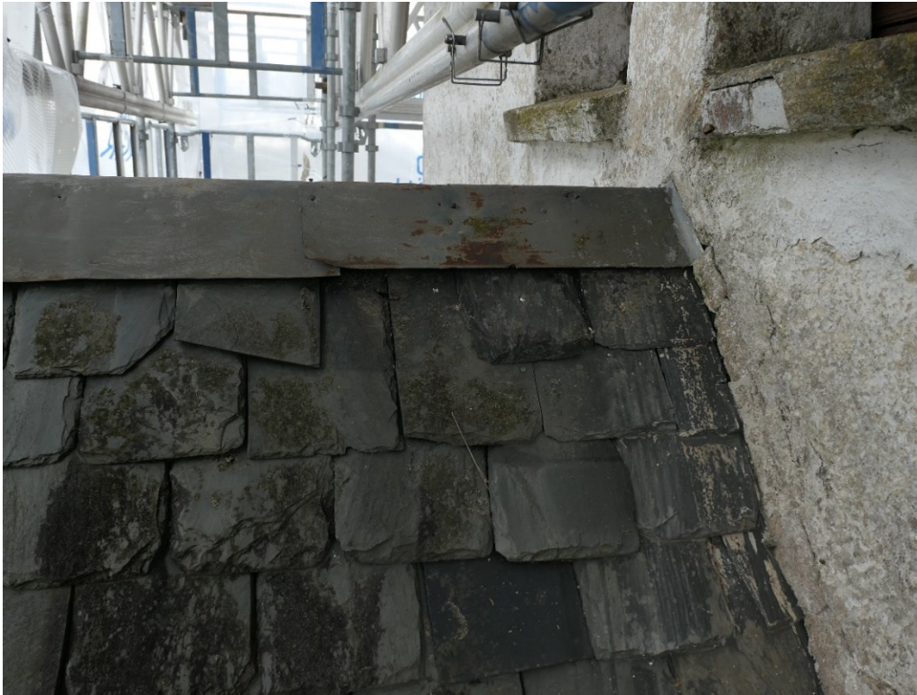
Före åtgärder. Långhustakets möte mot tornet.
