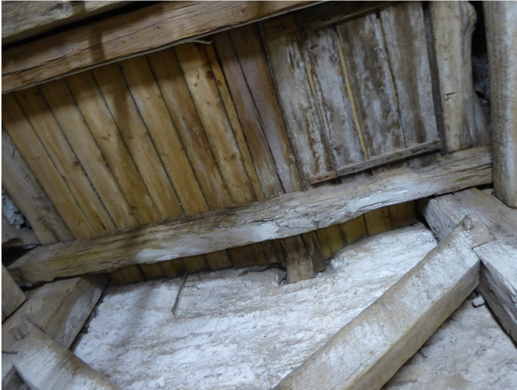
Före åtgärder. Golvet på klockvåningen sett från undersidan.
