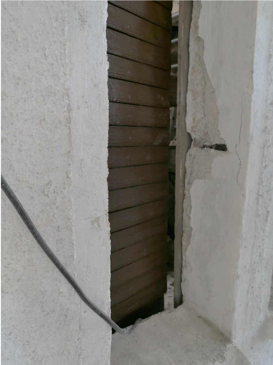
Före åtgärder. Exempel på ljudluckor och järn som orsakat spricka i murpelare mellan luckor.
