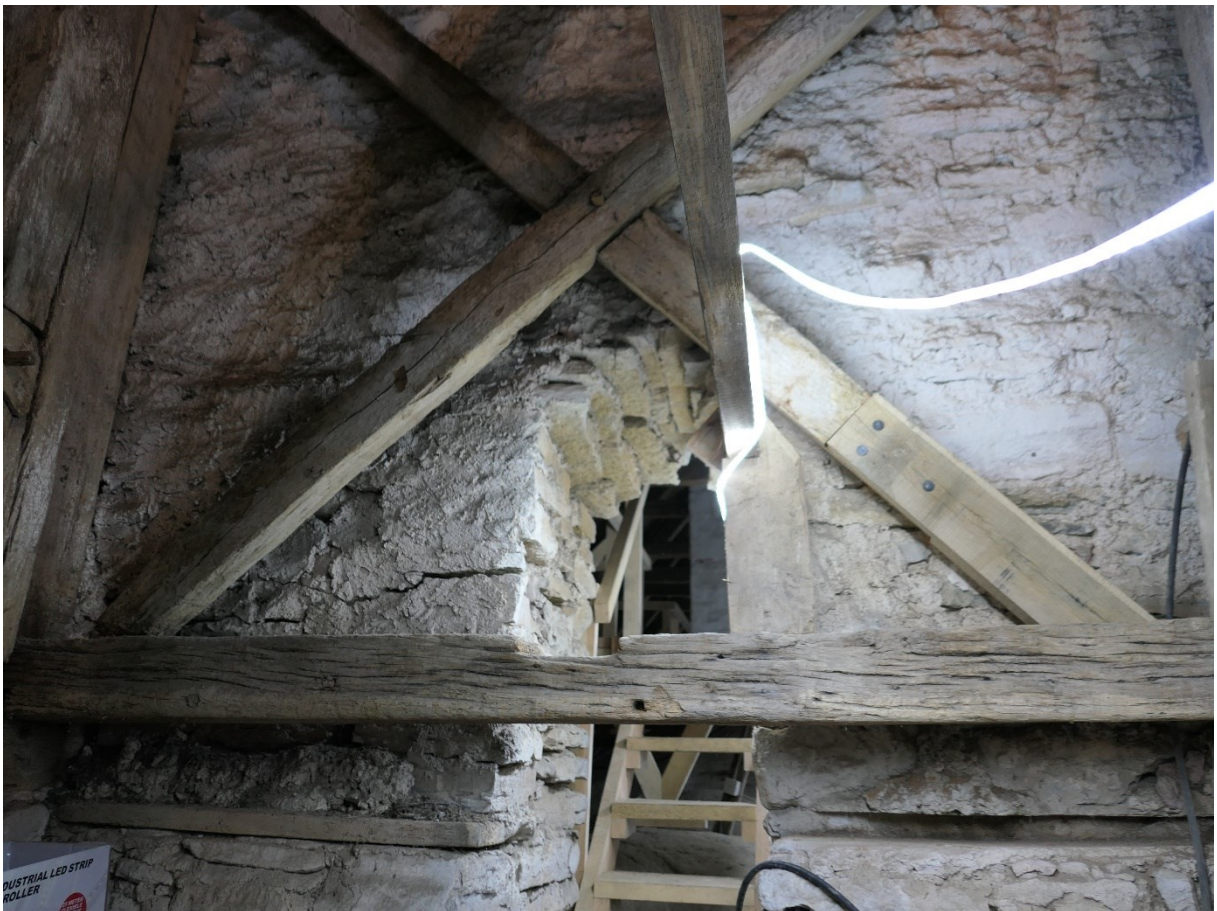
Tornets snedsträvor vid öppning mot långhus, mot öster. Före åtgärder övre vänstra bilden. Övre högra bilden och nedre bilden är efter åtgärder.
