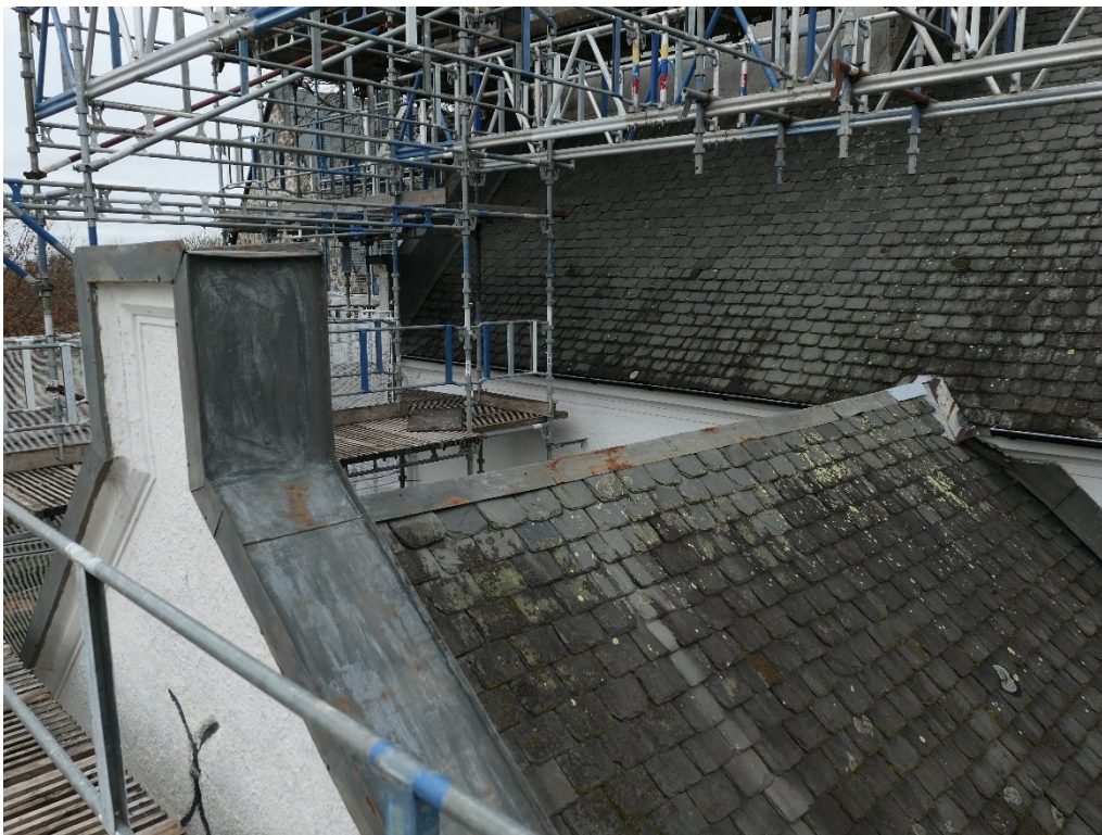
Före åtgärder. Vapenhusets tak och möte med långhustaket.
