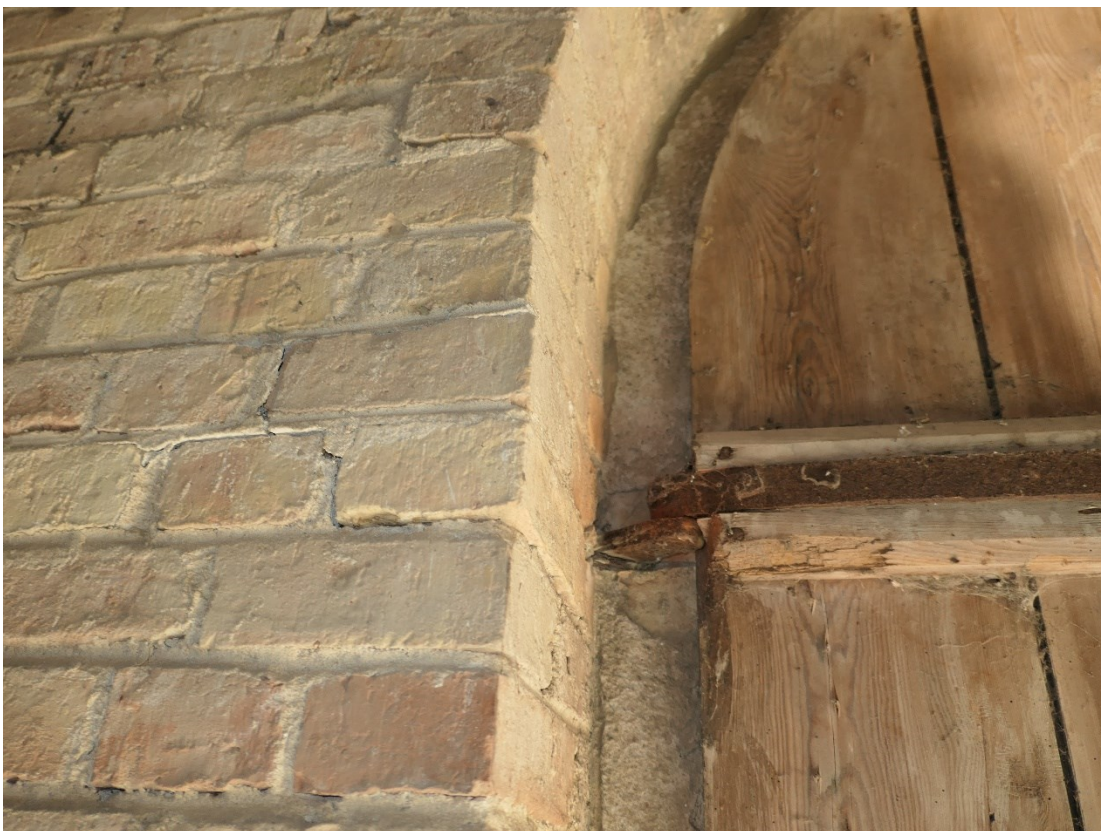
Före åtgärder. Merparten av gångjärnshakarna var kraftigt skadade av rost. Exempel på gångjärn och spricka i murverket.
