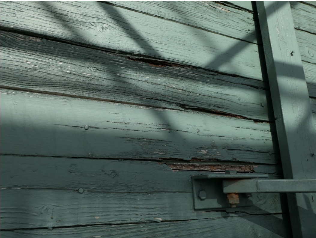
Före åtgärder. Södra ljudluckan utvändigt. Rötskadad träpanel.
