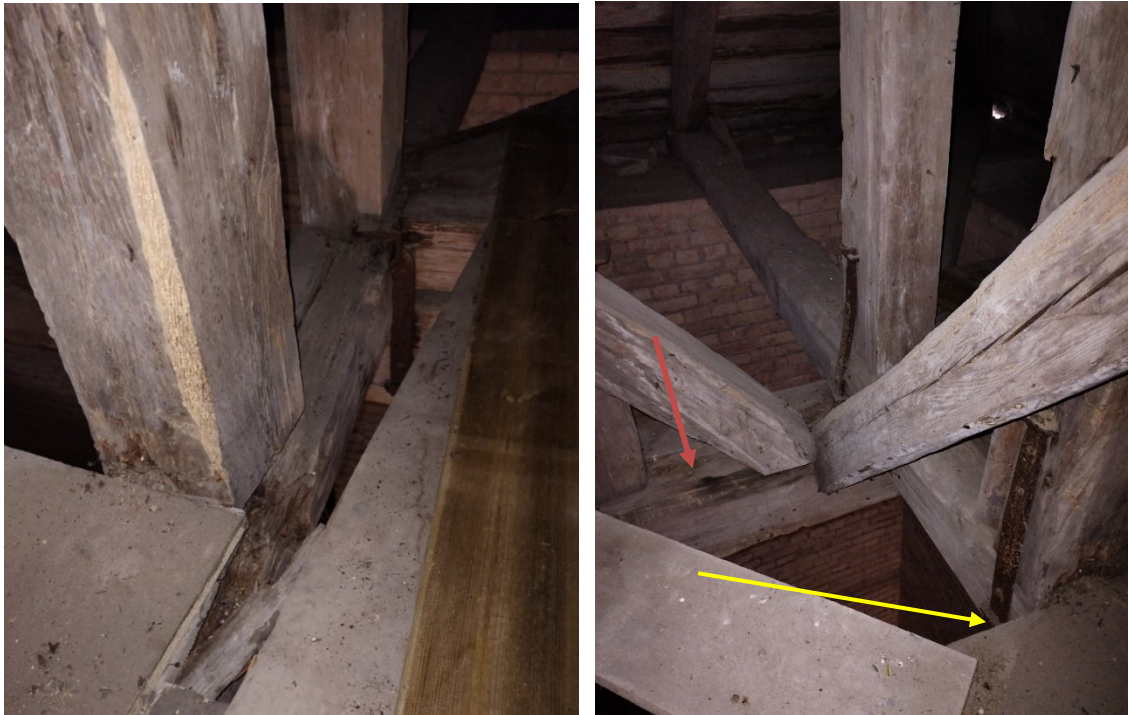
Före åtgärder, rötskada i den bjälke som markerats på ovanstående bilder. Gul pil visar på samma rötskada som på föregående bilder. Röd pil visar rötskada på bjälke som ligger under den förra.
