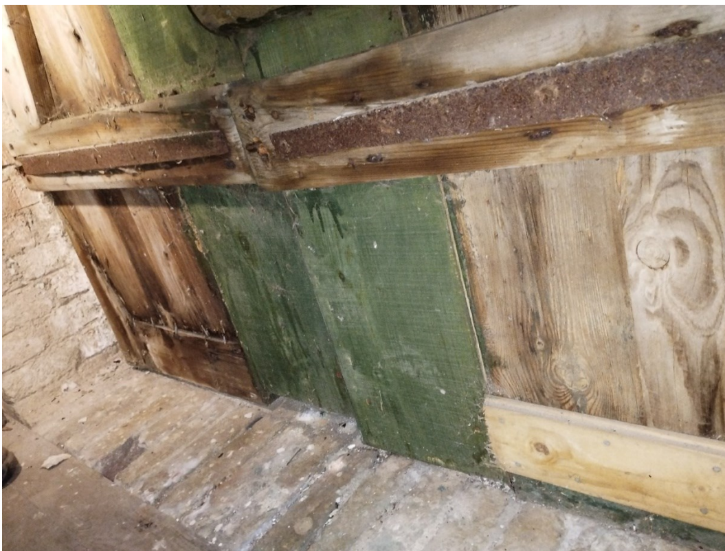
Före åtgärder. Södra ljudluckan, tidigare lappad och lagad och åter rötskadad.
