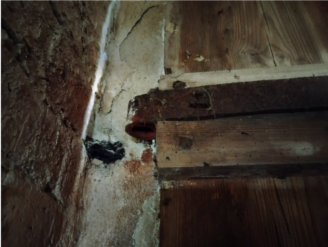
Före åtgärder. Västra ljudluckan, gångjärn som gått av.
