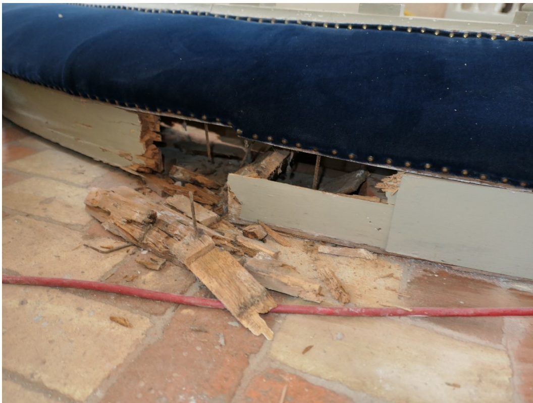
Rötskador i altarringens fundament.
