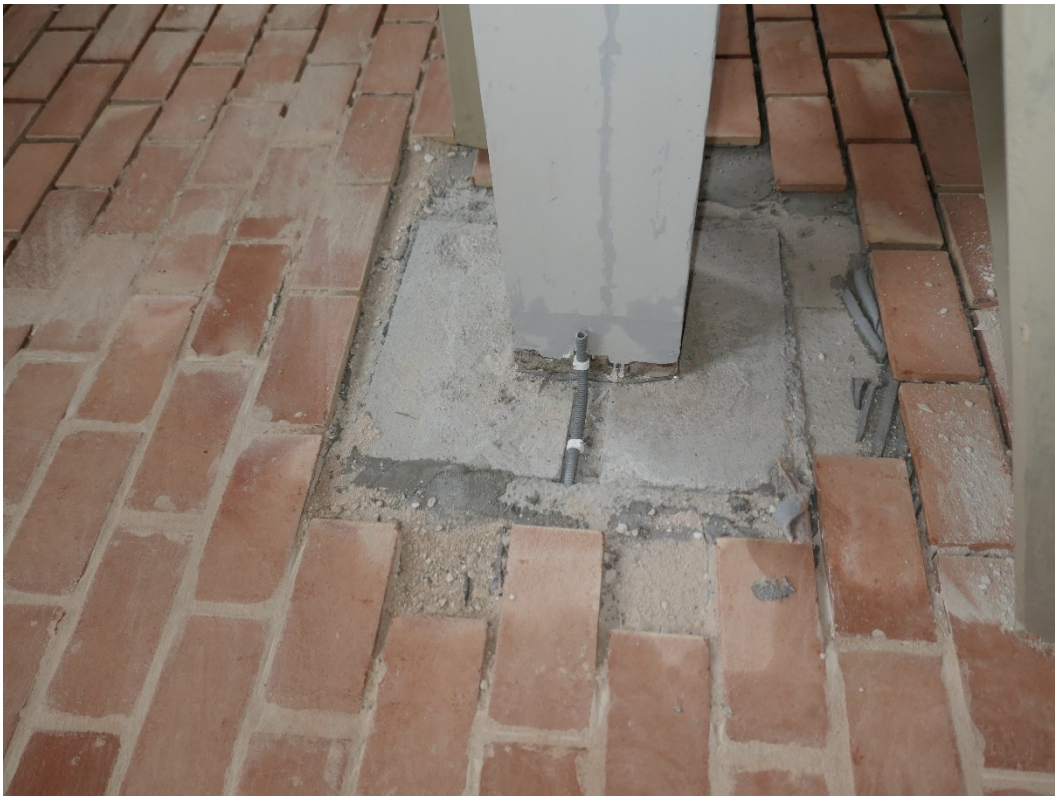
Exempel på kabeldragning för belysning fram till pelare. Arbete med tegelfogen pågår.
