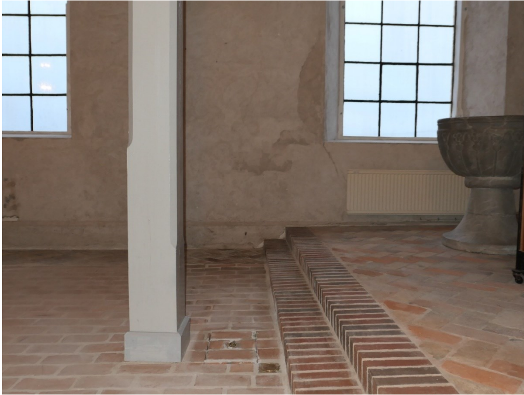
Dränaget är igenmurat invid väggen.
