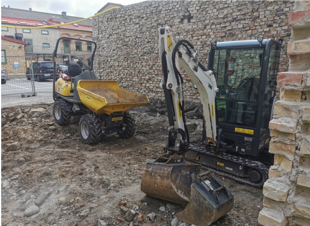
Figur 8. Maskinen var även placerad på de raseringsmassor som framkommit under befintlig husgrund. Fotografiet taget från sydväst.
