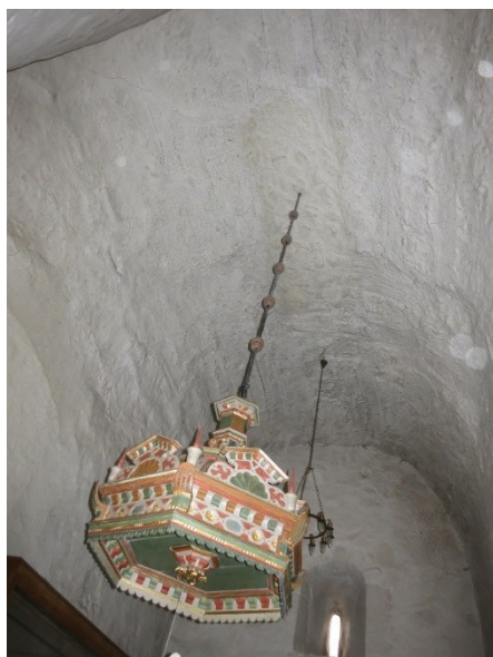
Figur 51. Över tornets bottenvåning slogs ett tunnvalv redan när det byggdes. Foto 2017 ©Kulturen.
