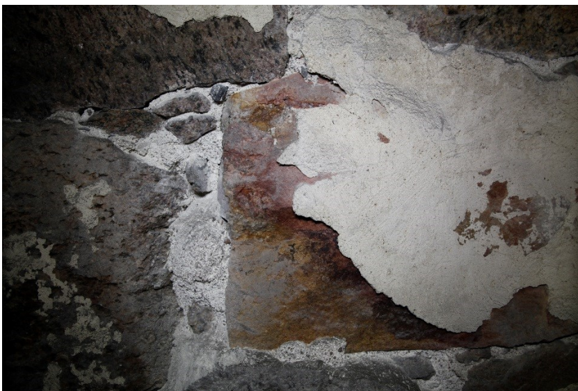
Figur 32. Rödfärgade stenar som kan vara påverkade av brand i långhusets östra vägg mot koret. Foto 2017 ©Kulturen.
