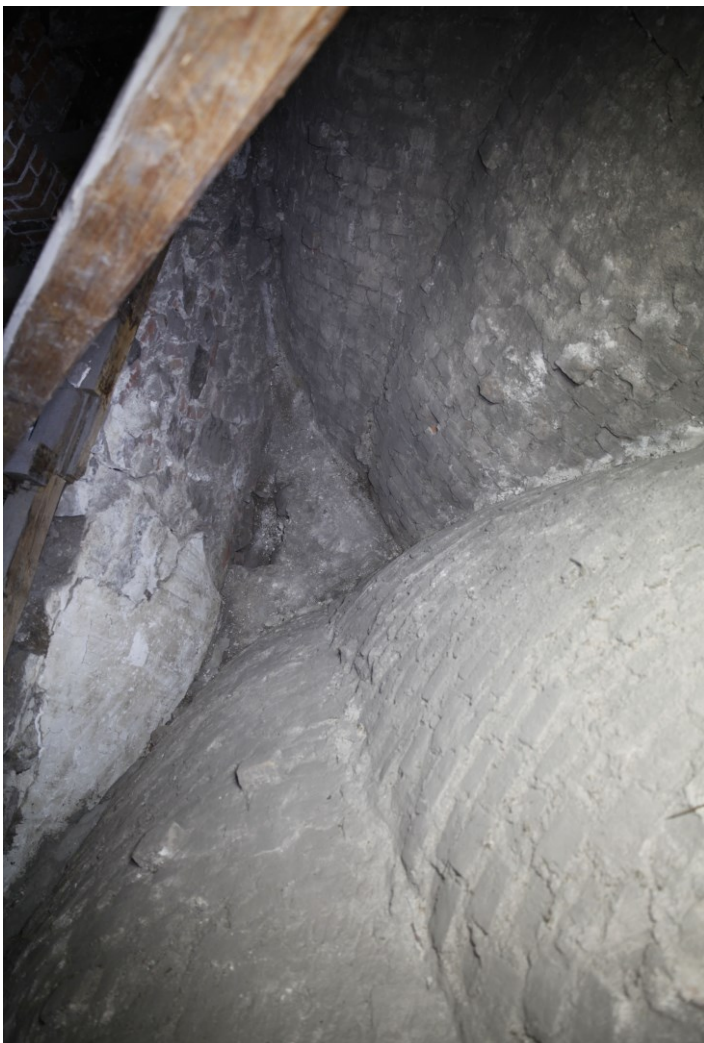
Figur 58. Valven över långhuset, sett ovanifrån på vinden. Foto 2017 ©Camilla Melin, Knadriks Kulturbygg.
