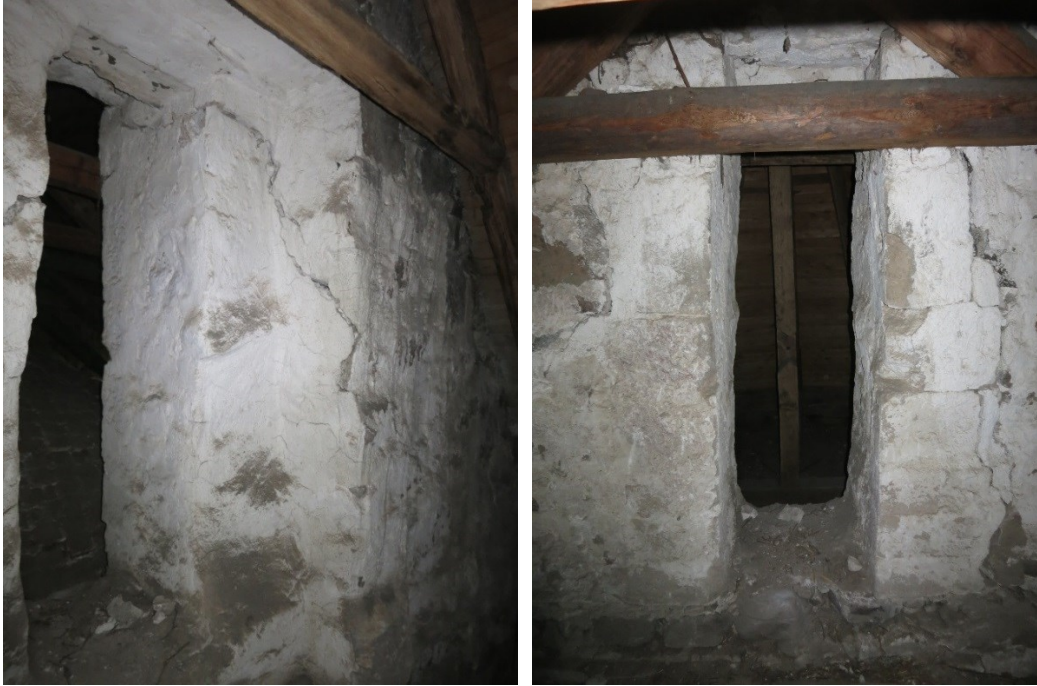
Figur 70. Portalomfattning mellan kor och absid på vinden. På båda sidor av portalen finns kraftiga sprickor i murverket. Foto 2017 ©Kulturen.
