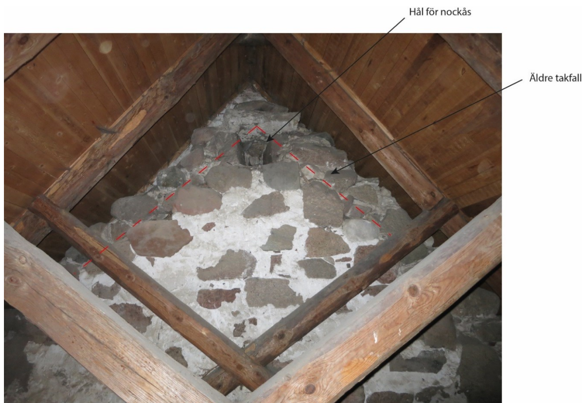
Figur 38. Att takfallet ändrats syns tydligt inne på korvinden, korets östra vägg. Foto 2017 ©Kulturen.
