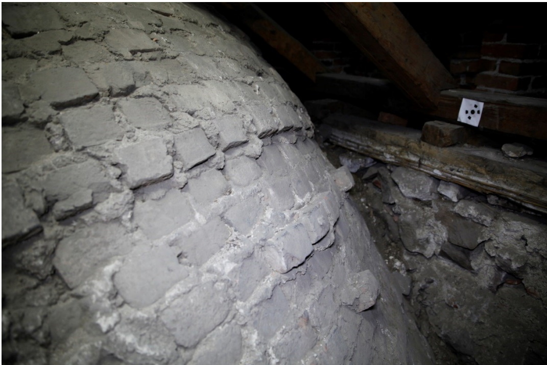
Figur 62. Valven kan vara murade underifrån vilket medverkat till att murbruket tryckts ut ur fogen. Muraren som stått på undersidan har inte strukit ut fogen, vilket annars är brukligt. Foto 2017 ©Camilla Melin, Knadriks Kulturbygg.
