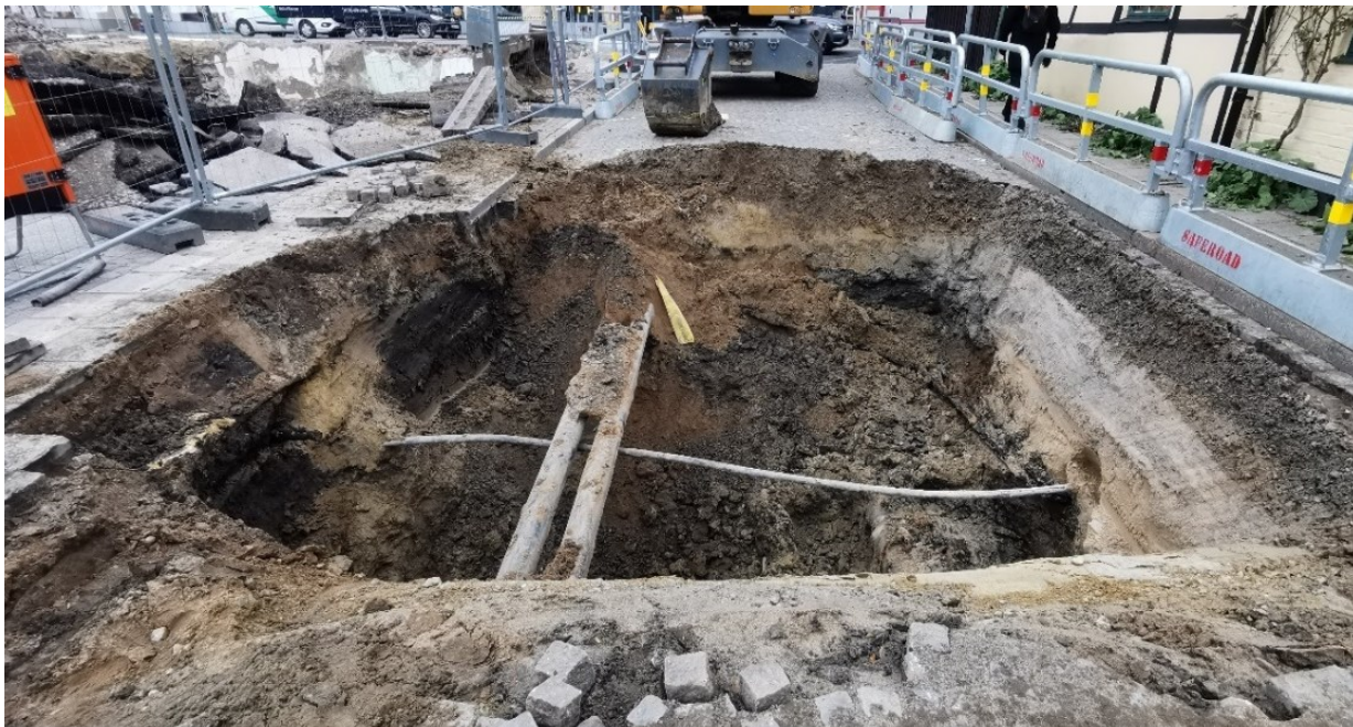
Figur 10. Översiktsbild över Schakt A_2023_0070 på Grynmalaregatan. Schaktbotten sluttade och fylldes gradvist med löst inrasat material, vilket utgjorde en säkerhetsrisk. Fotografi taget från söder.
