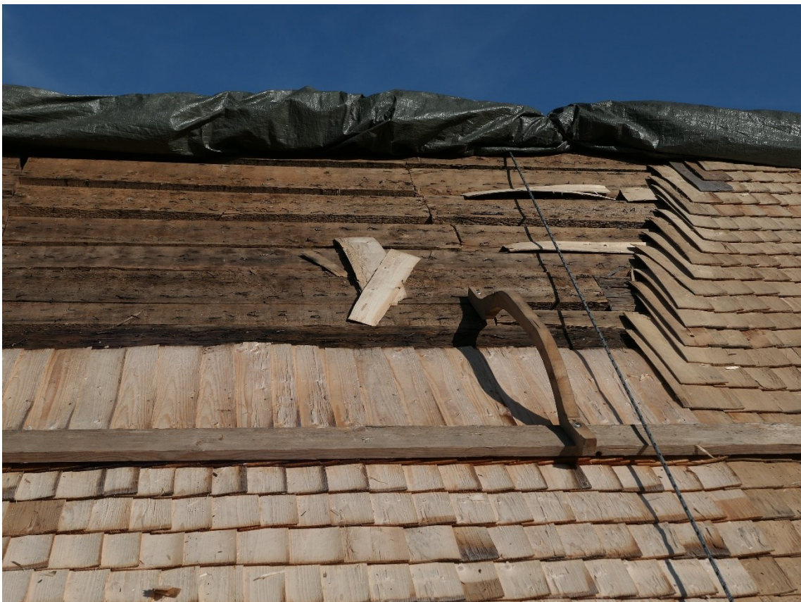
Under arbete. På bilderna skymtas även trobrädor som är något mörkare än övrig underbrädning.
