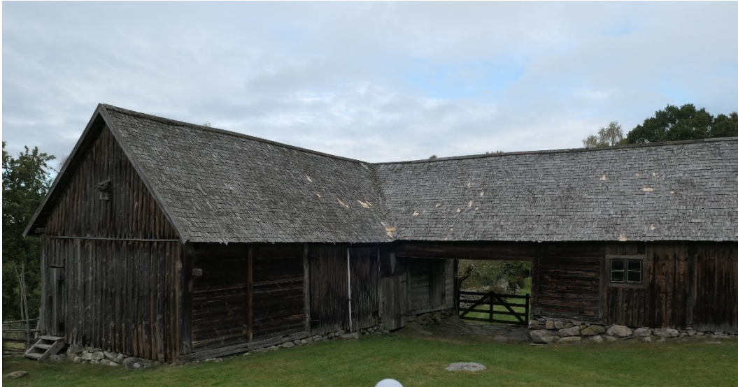
Västra och norra ekonomibyggnaderna med lagningar, syns som ljusa fält.
