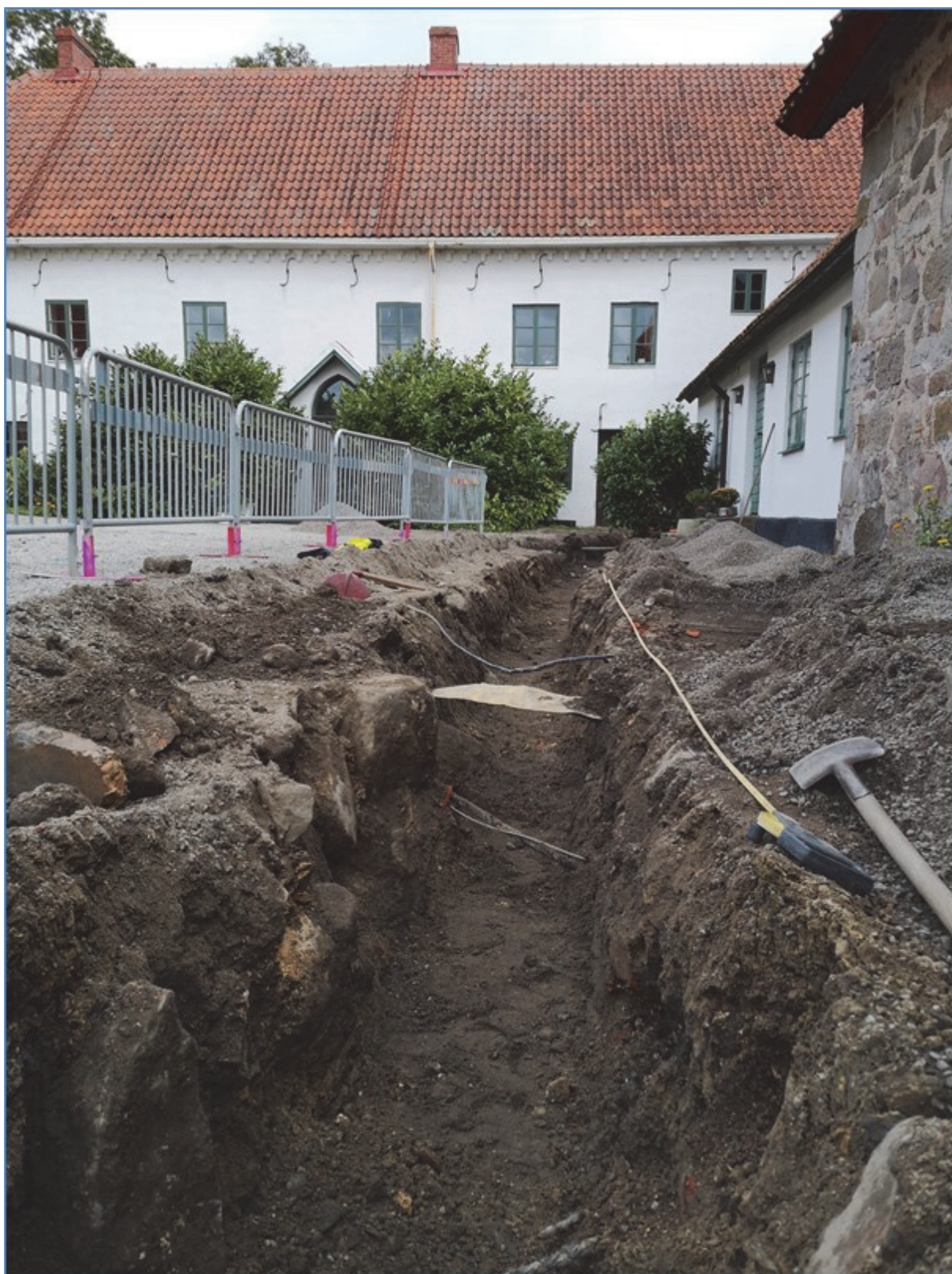
Figur 9. Det östvästliga schaktet mellan bostadshuset och ekonomibyggnad i väst följde ett äldre schakt. Sektionerna uppvisade en väldigt välbevarad fornlämning med riklig stratigrafi där flera grundmurar med intilliggande lergolv och ytor med värmepåverkad lera framkom. Fotografi taget från väst år 2020.
